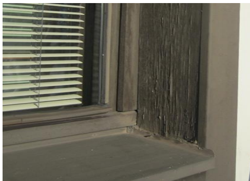
Kuva 2. Kuistin ikkunanpuitteen halkeilu.
