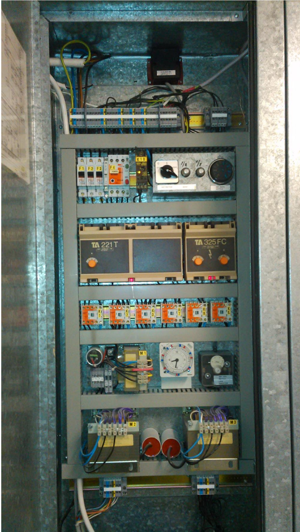
Kuva 2. Ilmanvaihtokoneen vanhat säätimet
