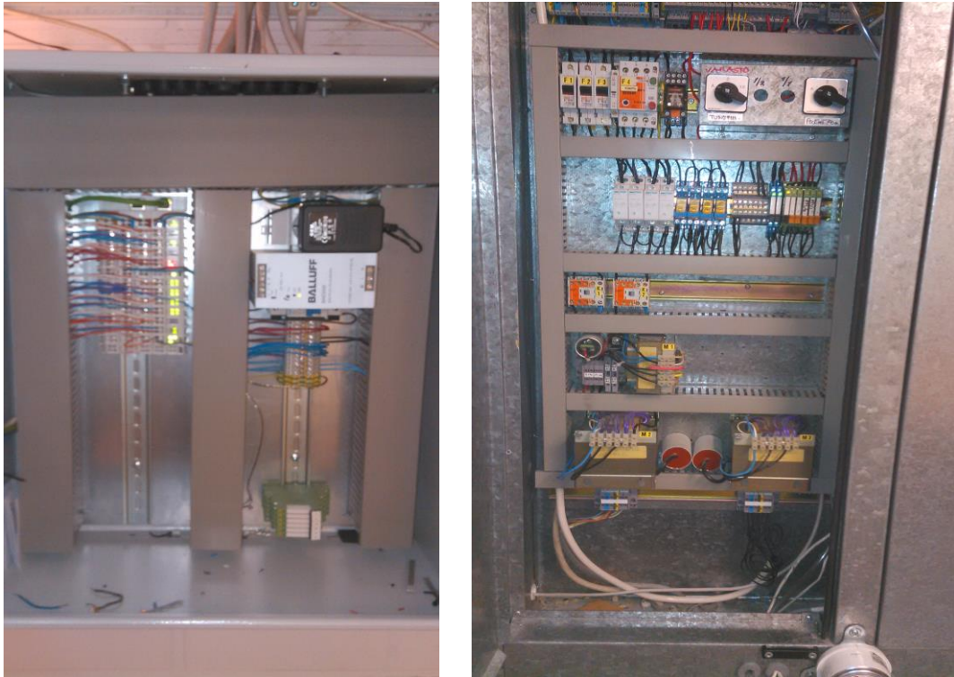
Kuva 3. Uusittu alakeskus, jossa prosessori sijaitsee, ja ilmanvaihtokoneen sähkökytkentätila, jossa vanhat säätimet sijaitsivat
