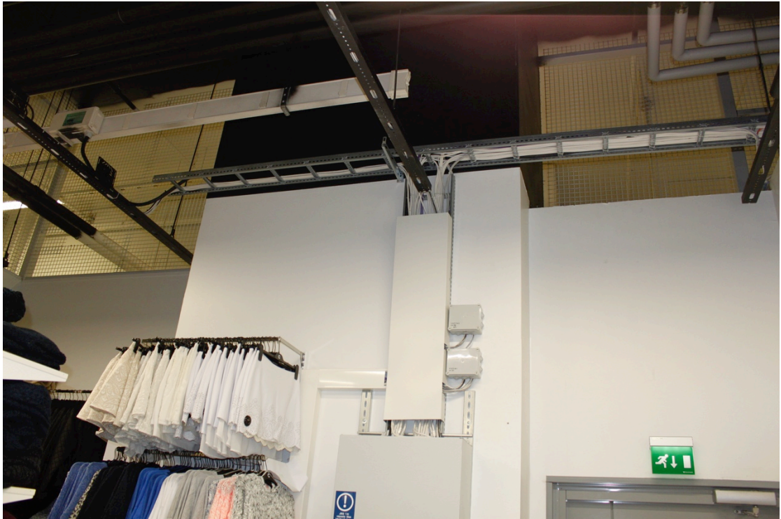
KUVA 7. Poistettu kiskon osa ja uusi loppupäätte Cubuksen takatilassa
