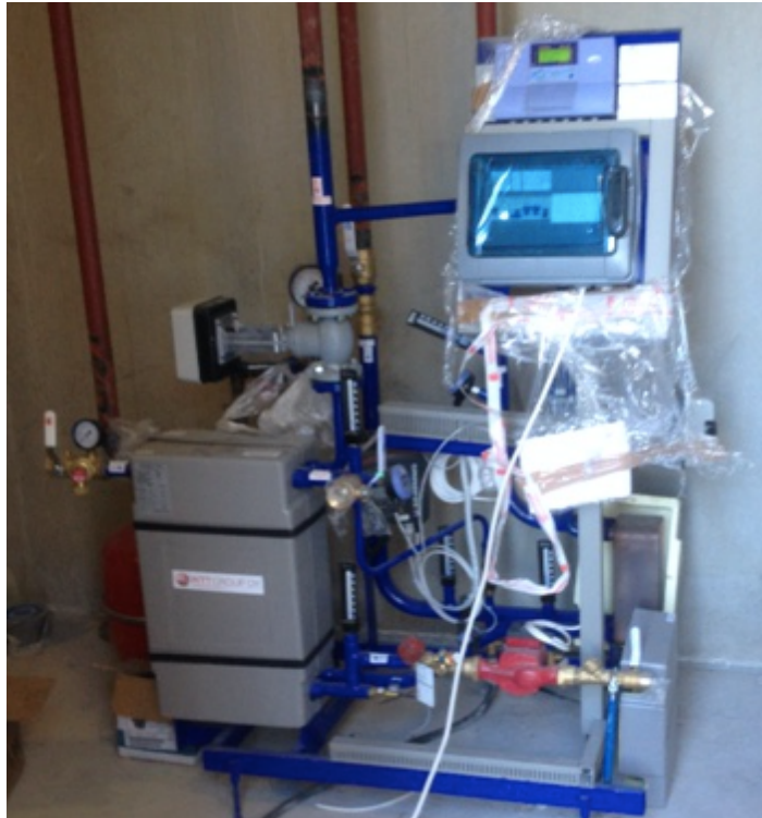
Kuva 6. Lämmönjakuhuoneen kaukolämpöyksikkö (Kuva: Otto Tevasaari).
