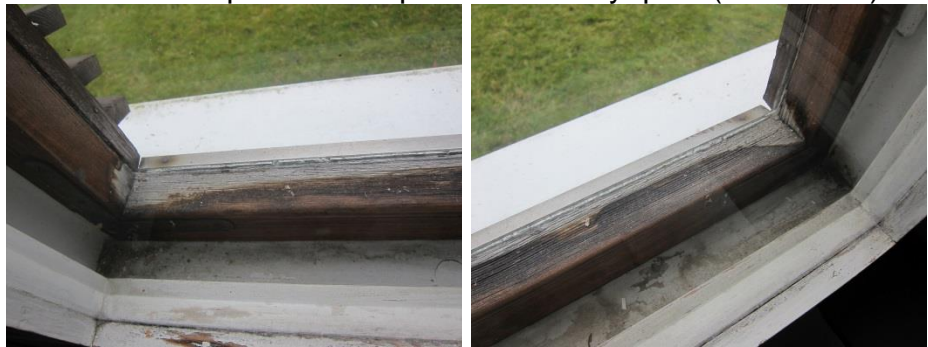
Sisäpuolen ikkunan pokista hilseillyt maali irti ja sitä on yritetty "korjata" teipillä (Asunto B1)
