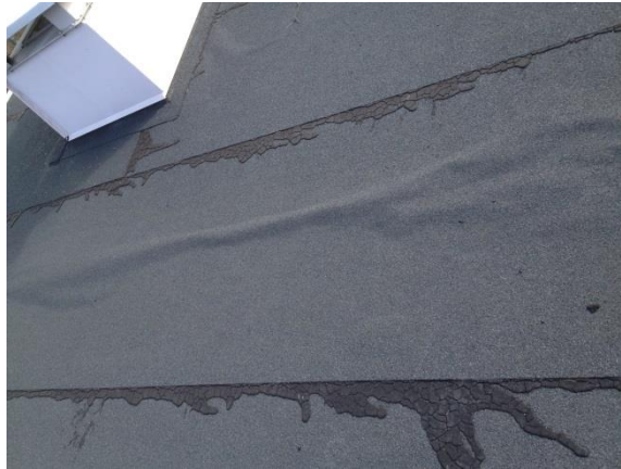
Kuva 5. Bitumikermiin on muodostunut ilmakuplia.
