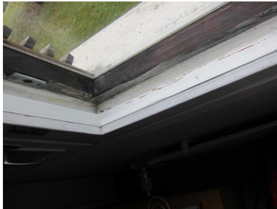
Kuva 6. Asukas on yrittänyt tiivistää ikkunaa teipillä.
