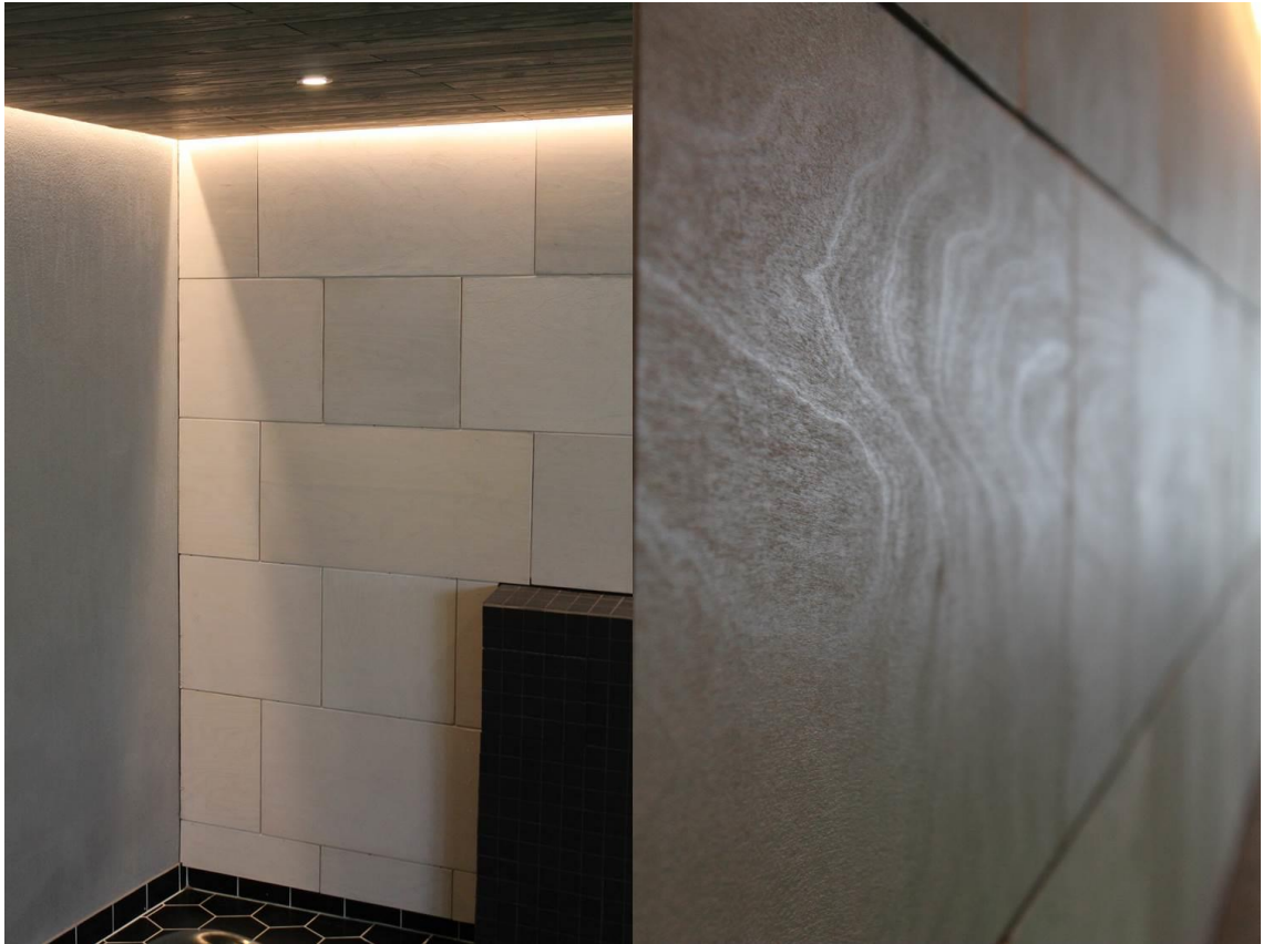
Kuva 38. Akustiikan parantamiseksi pitkän seinän pintamateriaalina on vaneri, joka on pintakäsitelty (Kuva: Terhi Ilvonen 2016h).
