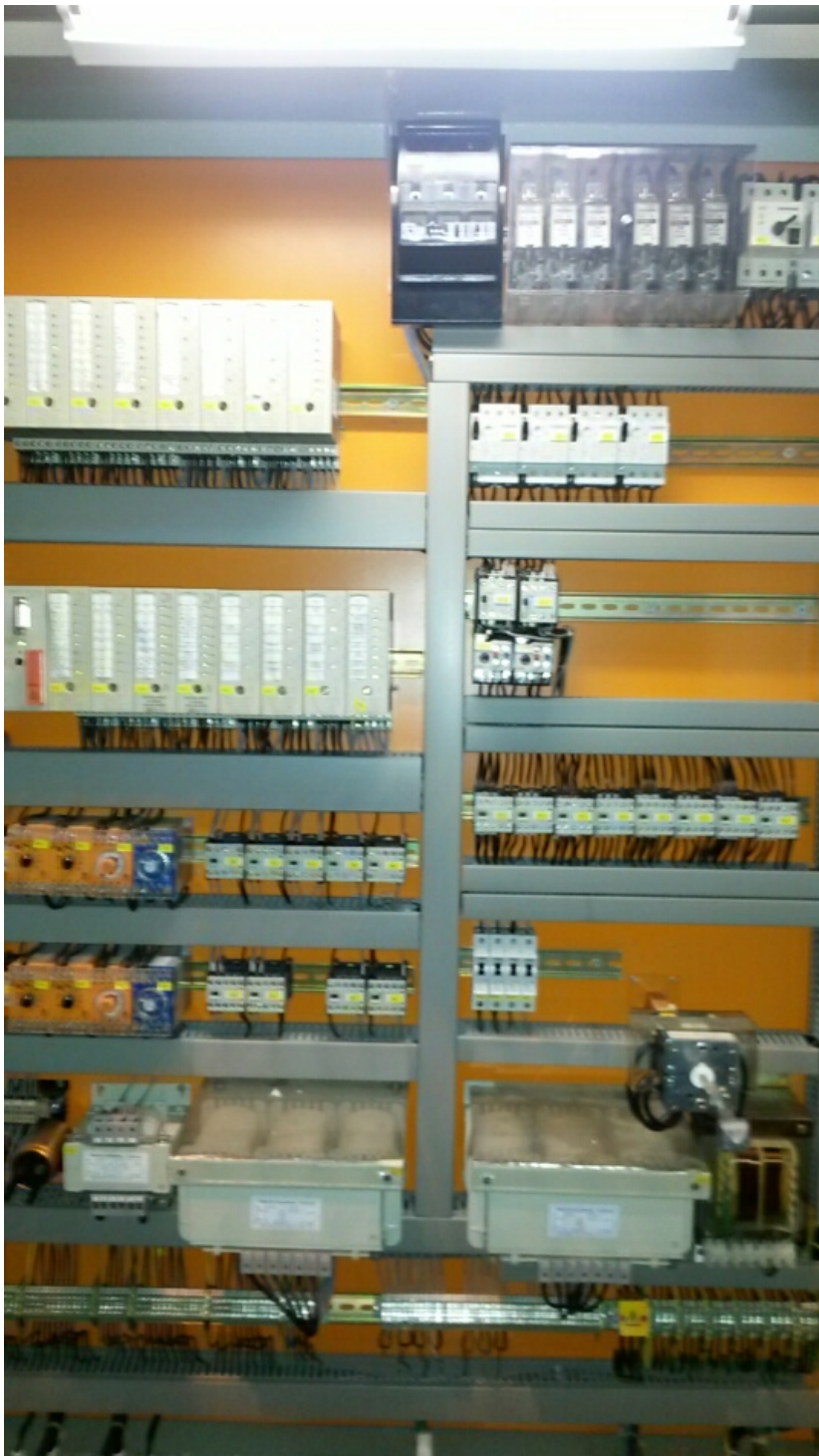
Kuva 11. CRM01 ohjauskaappi sisältä kuvattuna (Roininen 2015).
