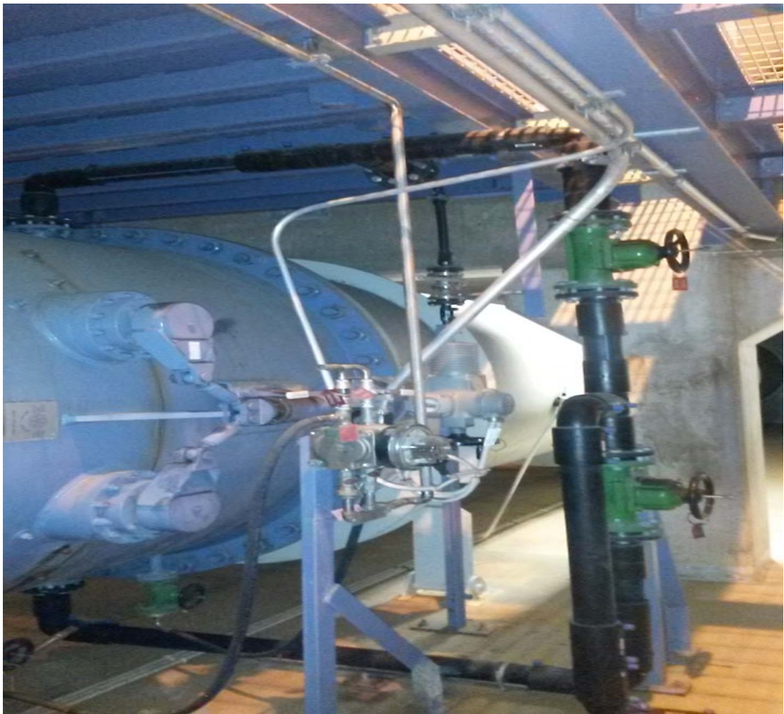
Kuva 9. Laitteiston seulalaite D2 ja paine-eromittauslaite 7D-M01 (Roininen 2015)
