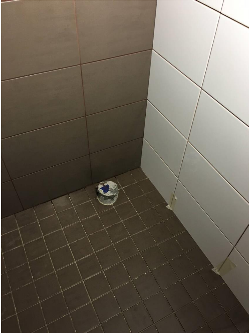
Kuva 8. Laatoitettu kylpyhuone saumausta ja silikoneja vaille
