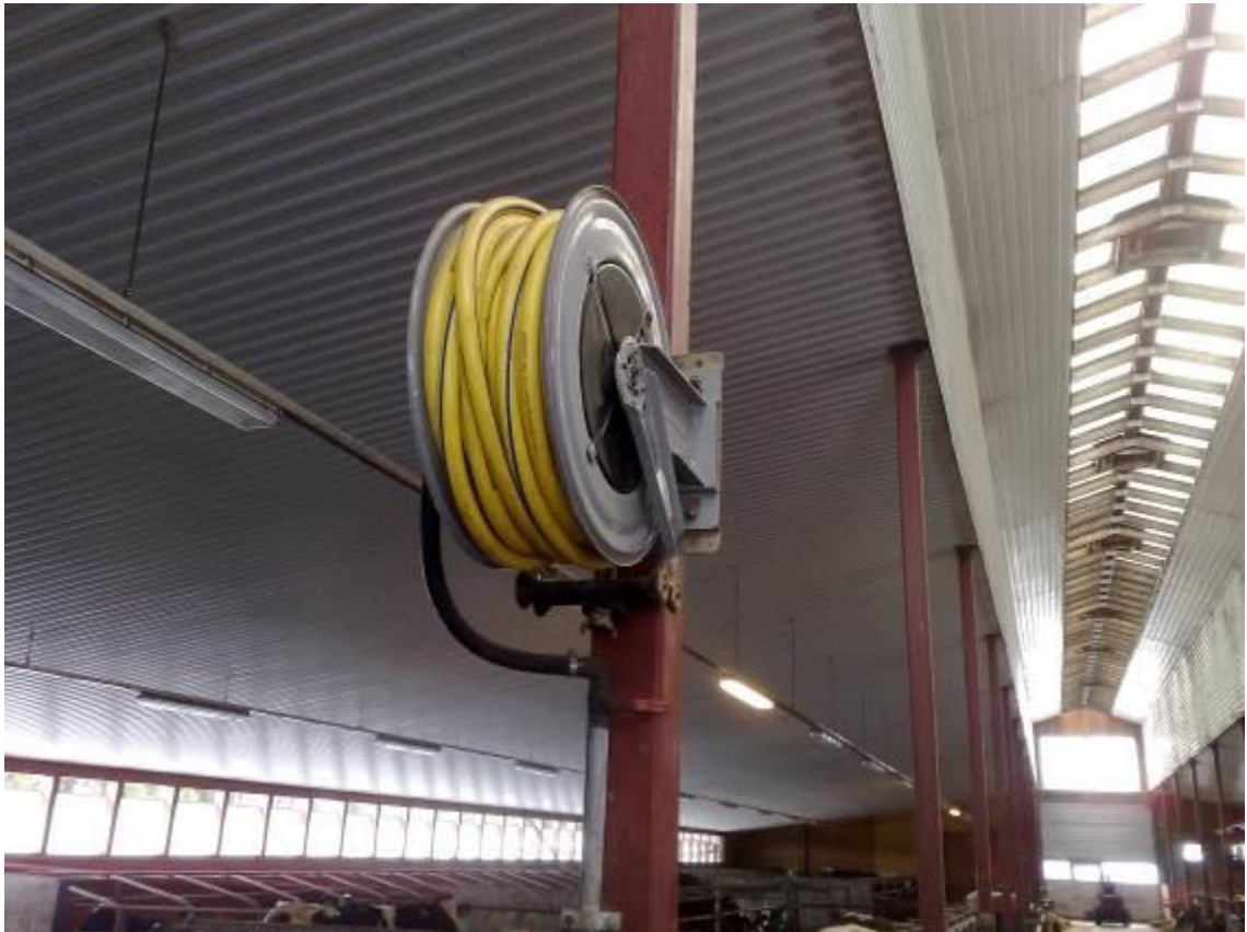
Kuva 5. Vesipiste letkuineen lypsyaseman vastaisessa päädyssä pihattoa (Kuva: Siiskonen 2016).
