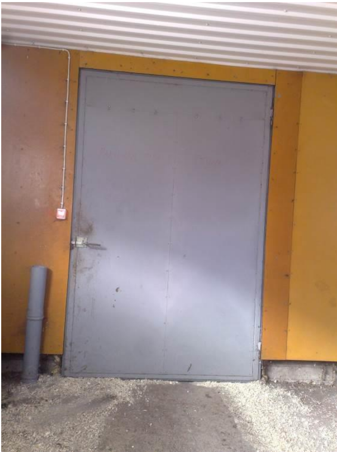
Kuva 1. Välikäytävän vanhan navetan puoleinen palo-ovi (Kuva: Siiskonen 2016).
