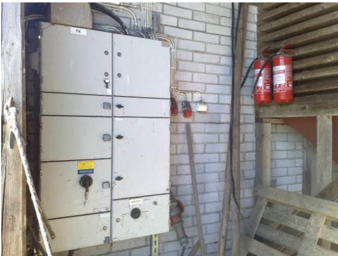
Kuva 19. Sähköpääkeskus ja jauhesammuttimet (Kuva: Siiskonen 2016).
