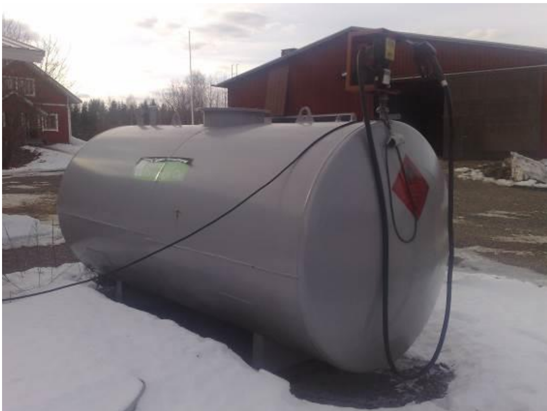
Kuva 18. Moottoripolttoöljyn varastointisäiliö (Kuva: Siiskonen 2016).
