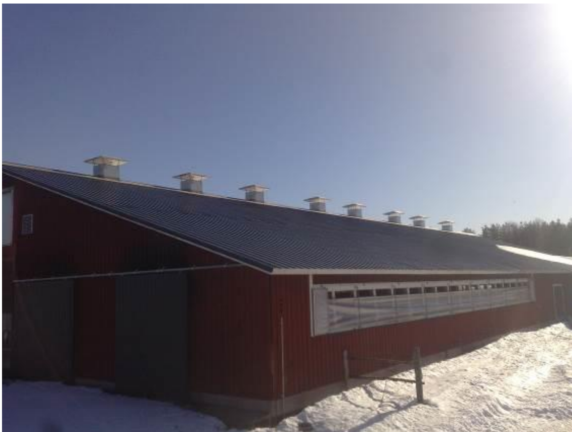
Kuva 2. Ilmanvaihto/savunpoistoreitit katolla sekä korvausilma-aukot seinällä (Kuva: Siiskonen 2016).
