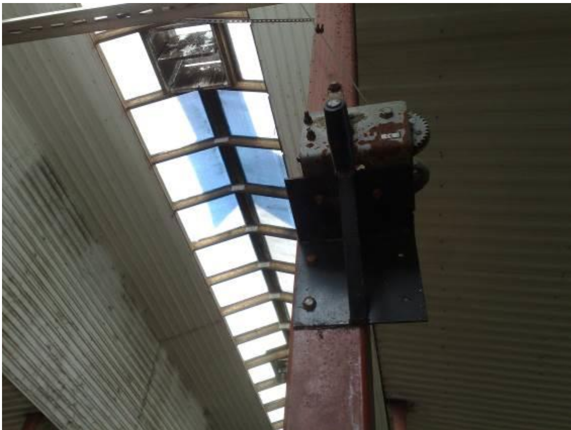
Kuva 3. Hormien säätövinssi (Kuva: Siiskonen 2016).
