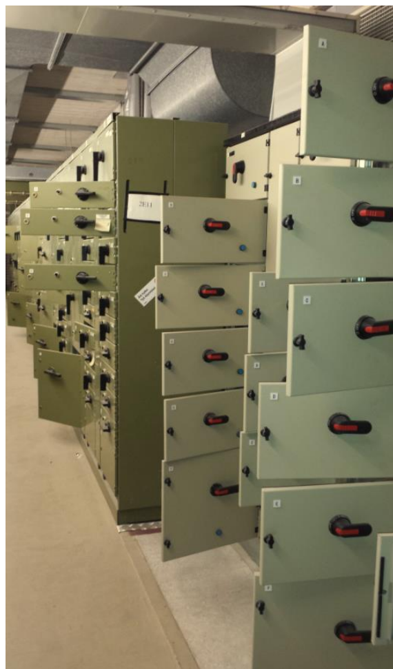
KUVA 10. Varaosakartoituksen aikana avattuja moottorilähtökeskuksien kennoja.
