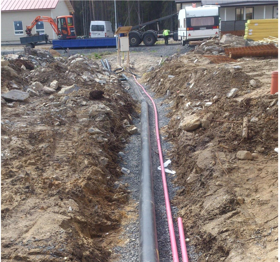
Kuva 6. Kaukolämpö ja varausputki
