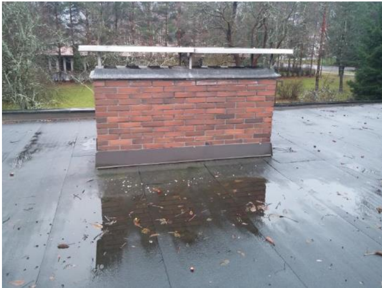
Kuva 2. Painuma katolla kerää vettä. (Kuva: Ari-Matti Pyylampi 2015)
