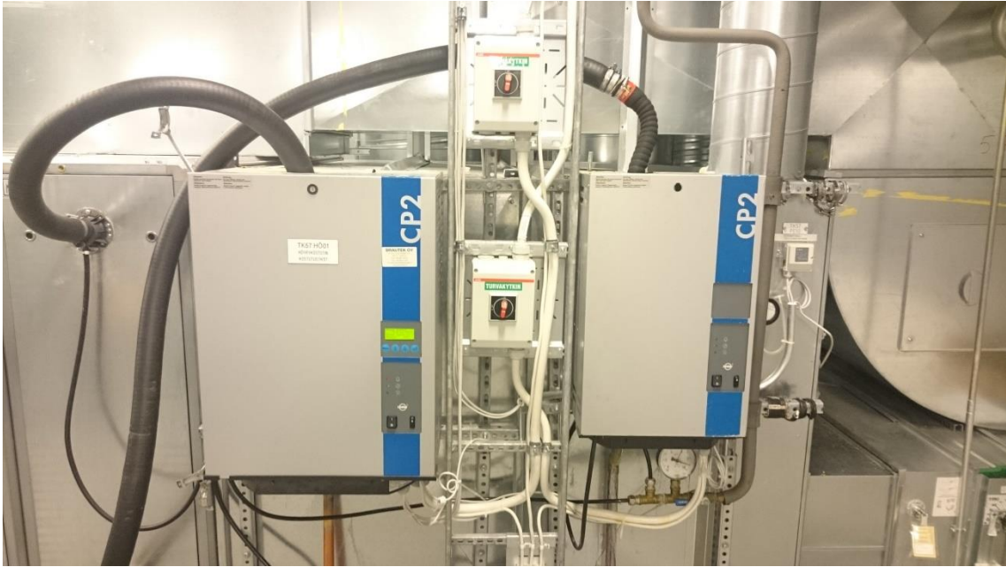
KUVA 1 IV-koneen TK57 höyrykostutin
