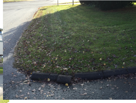
Kuva 3. Kunnanviraston edessä olevan nurmikokon reunakiveys osittain puuttuu. (Kuvat Nielsen)
