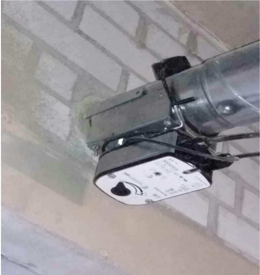
Kuva 2 Palopelti ilmanvaihtokanavassa, läpiviennin tiivistys paloakryylimassalla.
