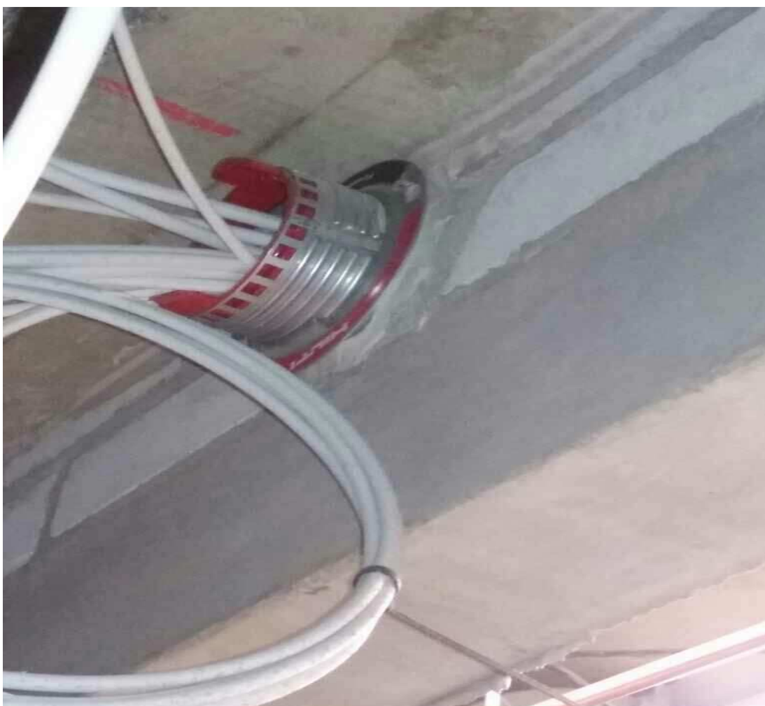
Kuva 3 Sähkökaapeleiden läpivienti palokatkokauluksessa, tiivistys paloakryylimassalla
