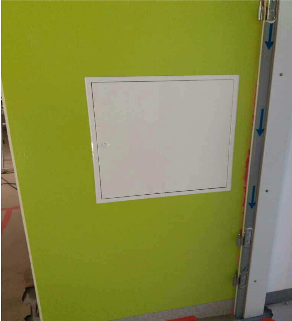
Kuva 8 Palonkestävä tarkastusluukku, tiivistys paloakryylimassalla.
