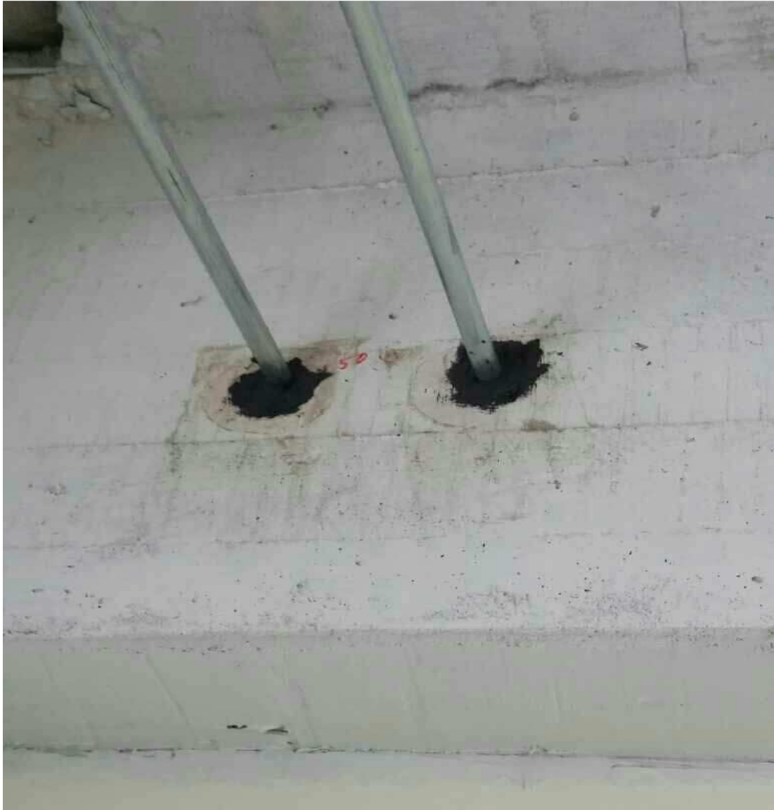
Kuva 6 Metalliputkien läpiviennit. Putkien ympärillä palovilla, tiivistys paloakryylimassalla.
