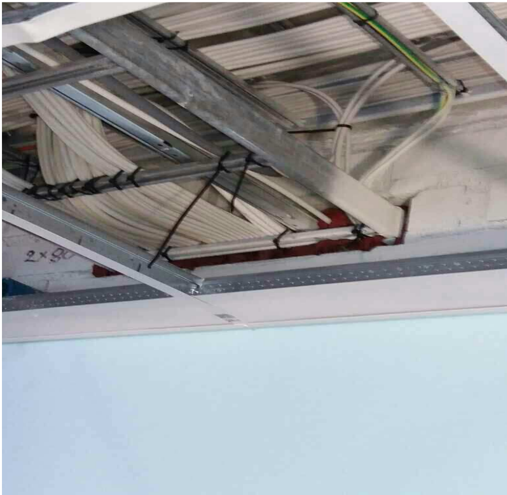
Kuva 4 Kaapelihyllyn läpivienti. Palokatko toteutettiin laajenevalla palokatkomassalla, joka mahdollistaa myöhemmin uusien kaapeleiden lisäämisen tarvittaessa.
