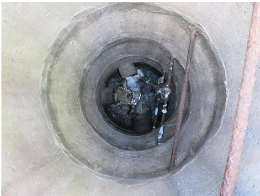
KUVA 1. Kaivon pohjalle on kertynyt paperia
