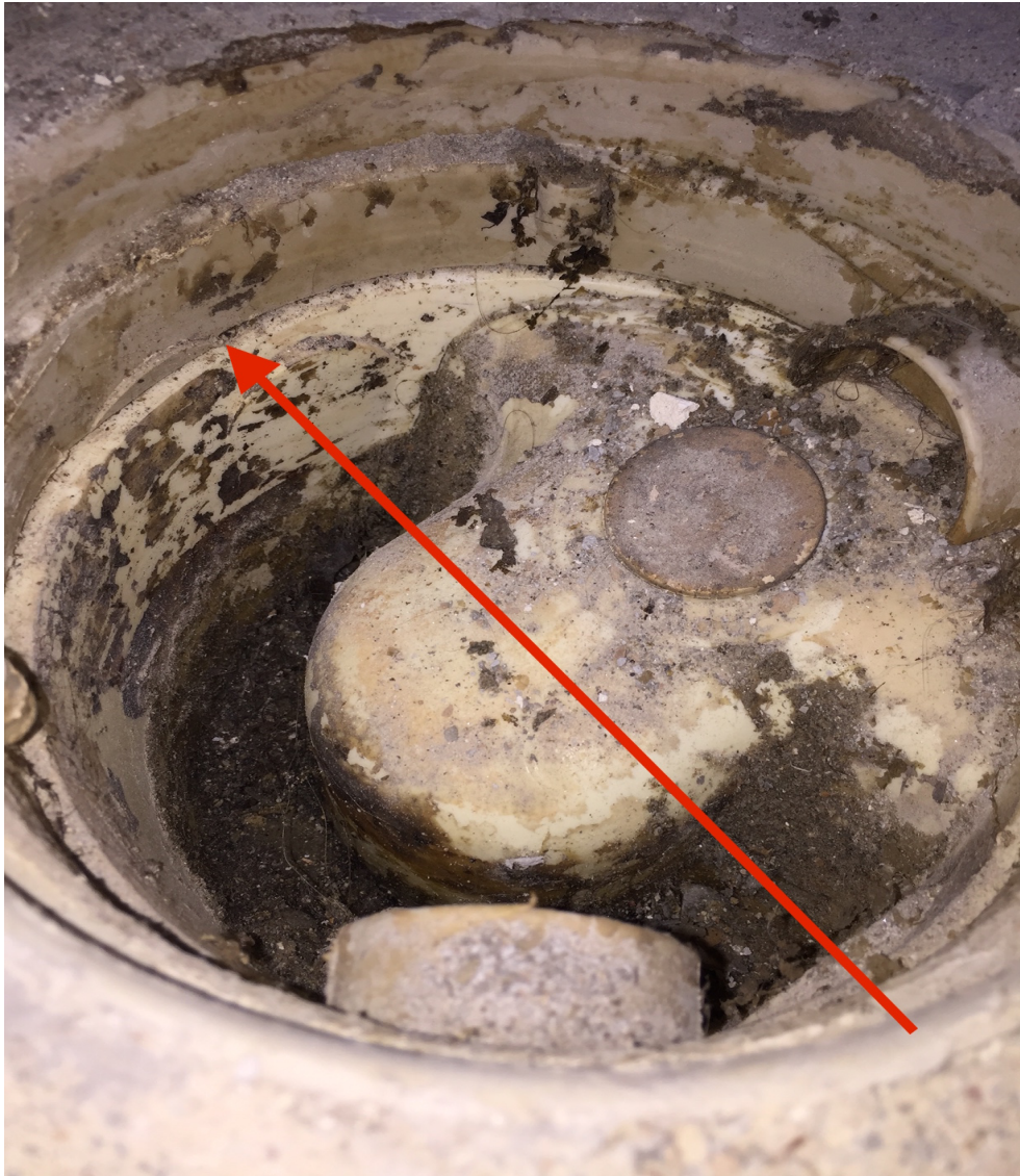
Kuva 21. Lattiakaivon tarkistus. Korokerenkaan ja kaivon välinen tiiviste on vaurioitunut. (Kuva: Valteri Salonen 2016)
