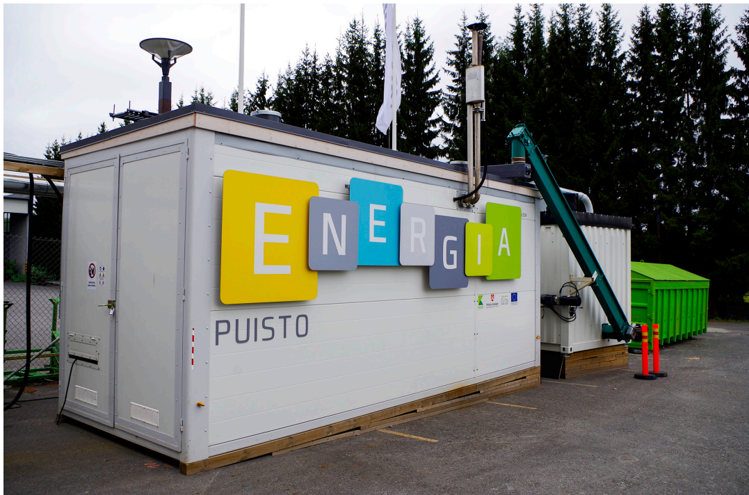
Kuva 1: Karelia-ammattikorkeakoulun opetus- ja tutkimuskäytössä oleva CHP-voimala tuottaa Sirkkalan Energiapuistossa osan koulukiinteistön sähkö- ja lämpöenergiasta (Kuva: Harri Pietiläinen).
