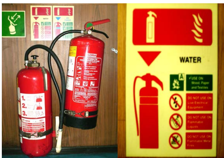
Kuva 1. A-luokan paloihin sopivat sammuttimet sekä opastusmerkki.
