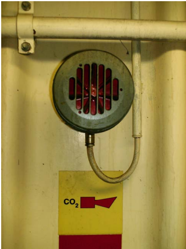
Kuva 27. Konehuoneen CO 2 -hälytyskello ja symboli.
