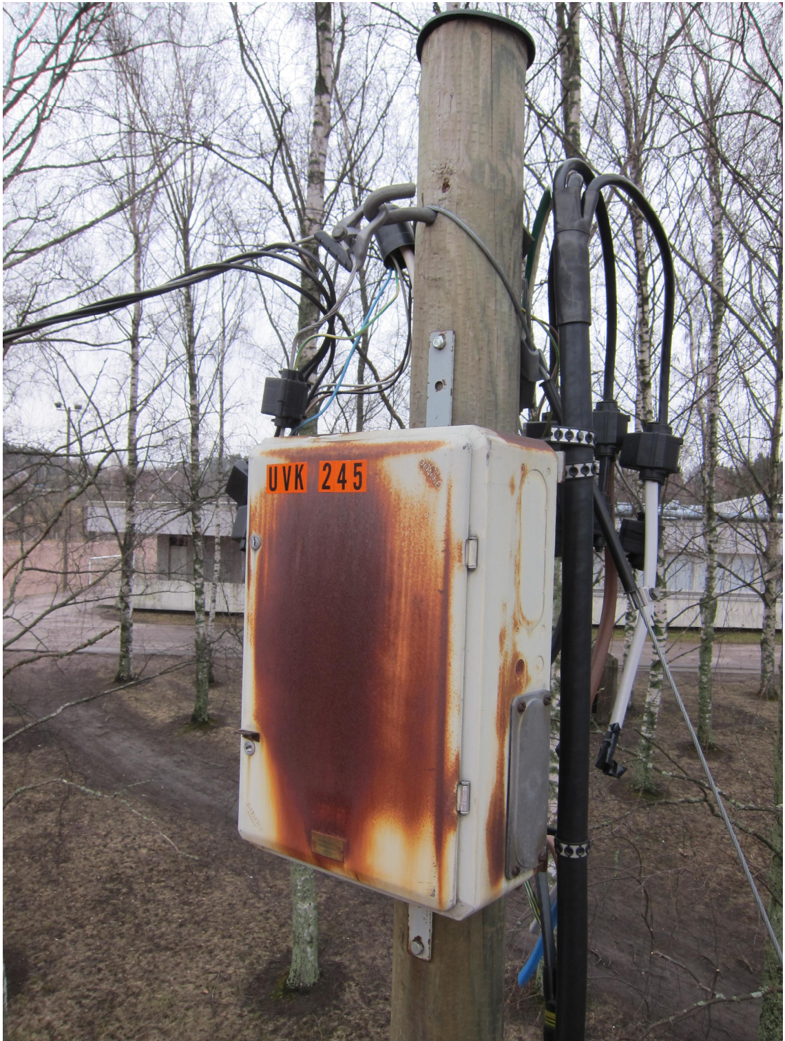
Kuva 3. Saneerausta vaativa UVK245 kuvattuna 2014 vuoden kiinteistöjen valaistuksen kartoituksen yhteydessä (Keravan katuvaloverkoston suunnittelu 2016).
