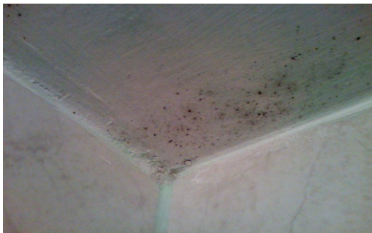
Kuva 1. Mikrobien aiheuttamia mustia pisteitä katossa. [9.]
