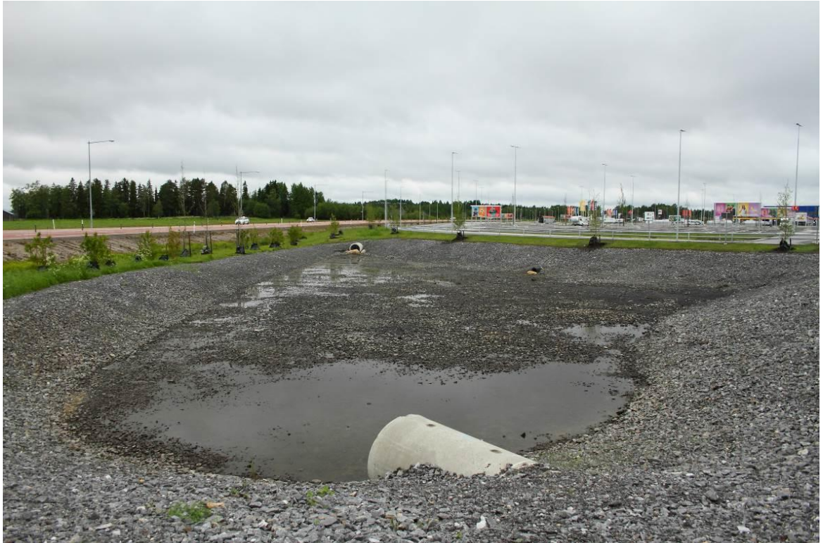
Kuva 9. Hulevesien viivyttämisallas liikekeskuksen pihalla Uumajassa.
