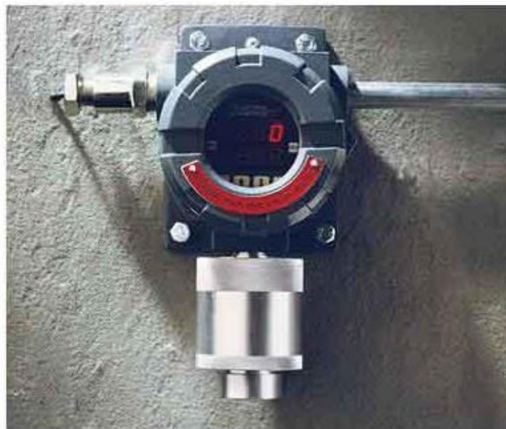
KUVA 19. iTrans-kaasuilmaisin asennettuna seinälle (Oldham 2016)
