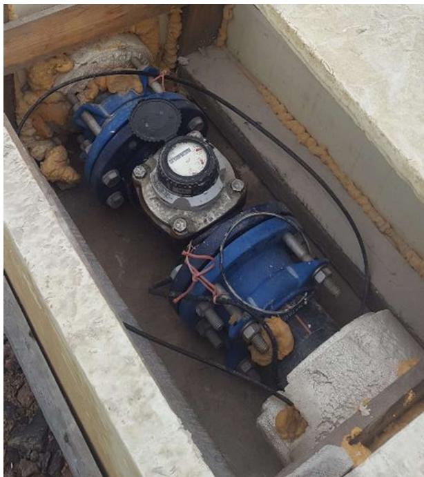
Kuva 15. Työmaalla käytössä oleva pumpattavanveden mittari.
