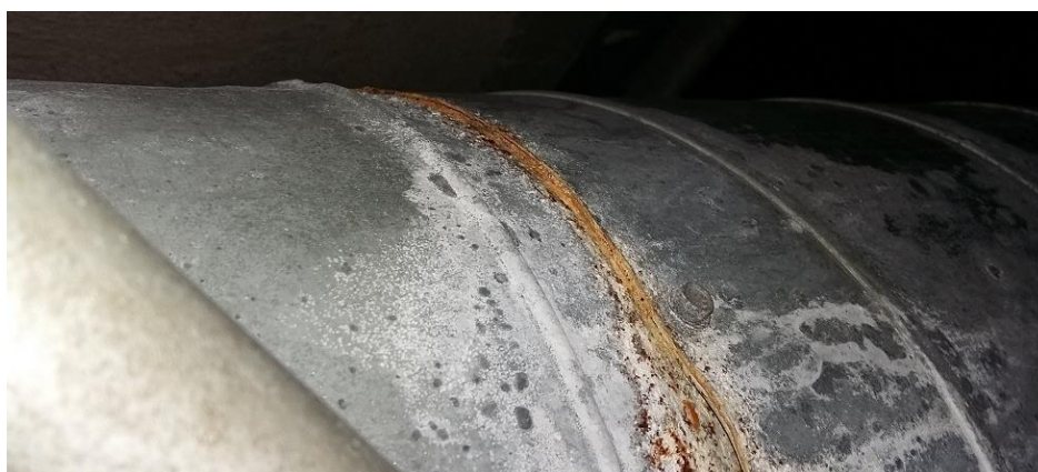
Kuva 3. Kanaviston saumassa havaittu rakokorroosio
