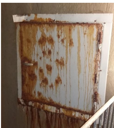
Kuva 10. Maalattu huoltoluukku on alkanut korrosoitua pinnoitteesta huolimatta
