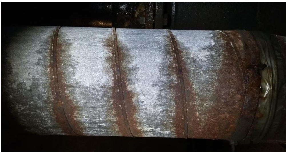
Kuva 4. Pahoin korrosoitunut ilmanvaihtokanava kaukolämpötunnelissa.
