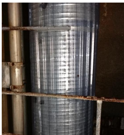
Kuva 5. Kuilun pystykanava on kauttaaltaan suojattu akryyliaaltolevyllä
