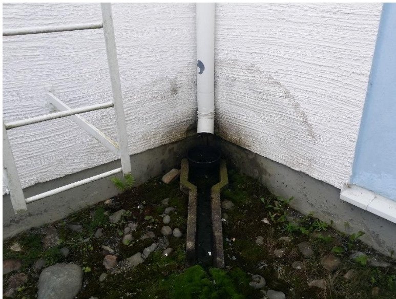
Kuva 11, Kosteusvaurioita kulttuurikeskuksen kivijalassa.
