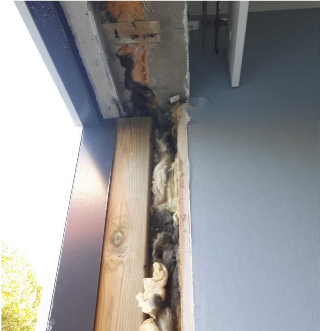
Kuva 2. Ilmavuoto ikkunan ja seinän välistä on tummentanut vanhoja eristeitä.
