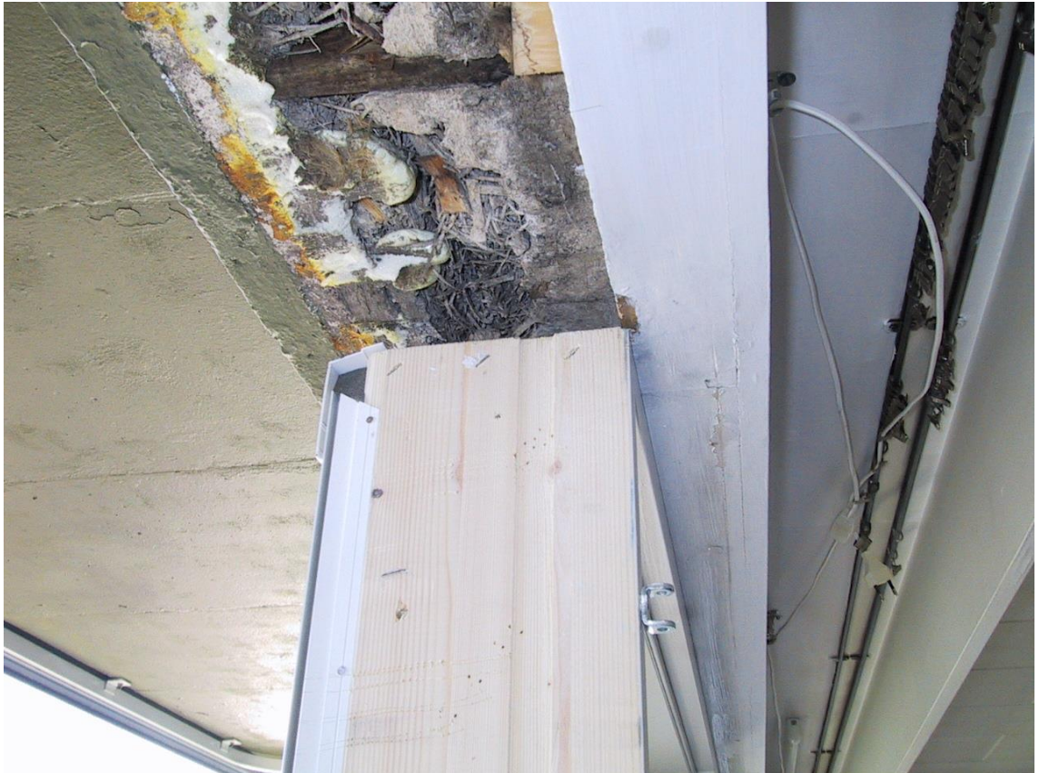
Kuva 17. Ikkunan yläkarmi, joskus on vaikea löytää kiinnitysruuveille tartuntapintaa (J.-P. Tuominen, henkilökohtainen tiedonanto 1.9.2016).
