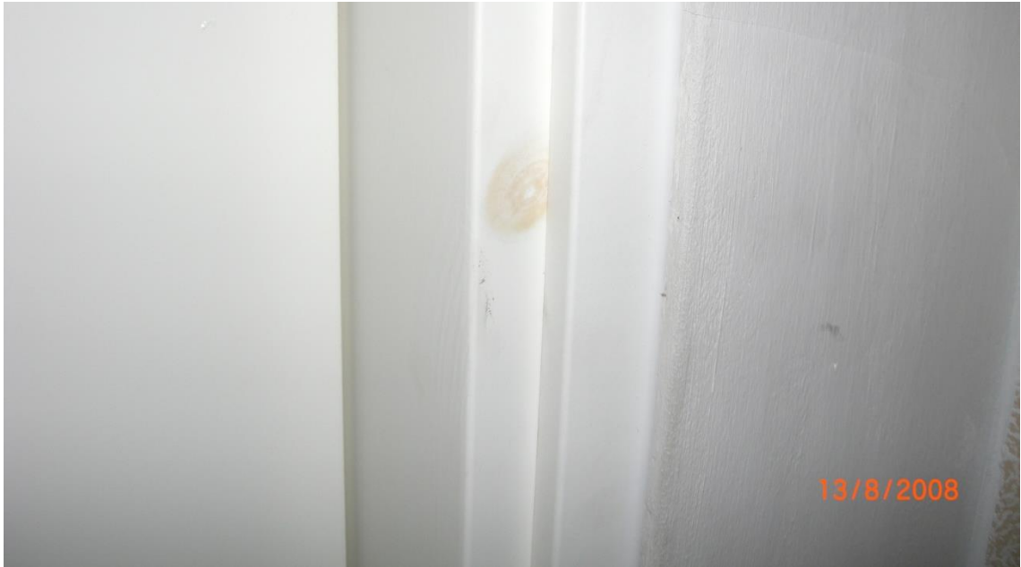
Kuva 3. Oksakohdan pihka tulee läpi uuden puitteen maalipinnasta (J.-P. Tuominen, henkilökohtainen tiedonanto 1.9.2016).
