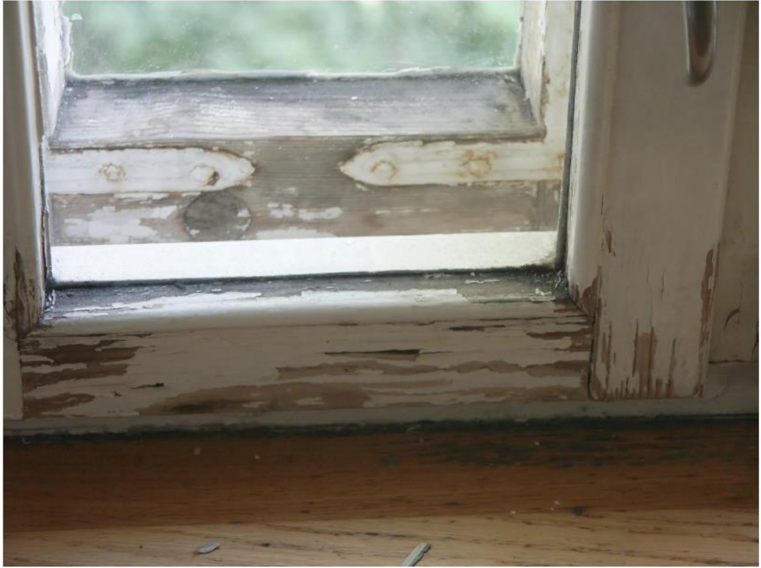
Kuva 6. Puutteellisen huollon vuoksi vaurioitunut ikkuna (K. Hemmilä & J. Nieminen. Ikkunoiden käyttö, huolto, kunnossapito ja remontointi 2008).
