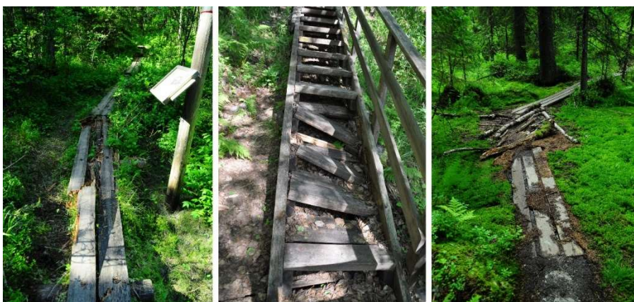
Kuva 3. Kolin kansallispuiston huonokuntoisia rakenteita (Kuvat: Marita Kivioja).
