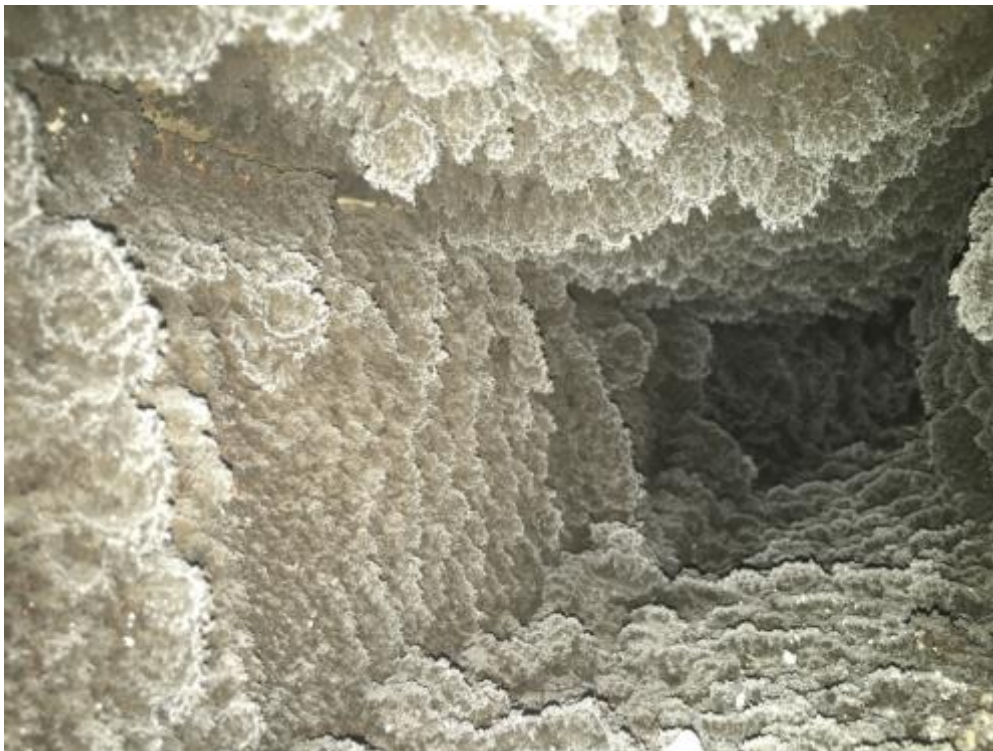
Kuva 4. 1960-luvun kerrostalon puhdistamaton betoninen ilmahormi.
