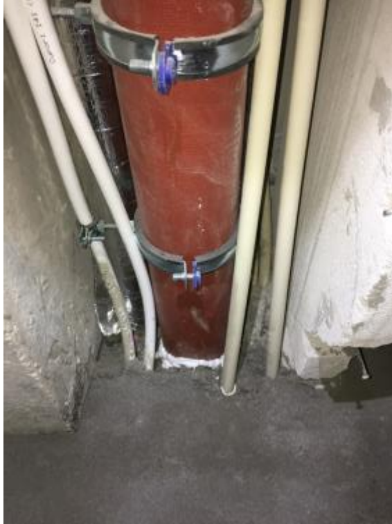
Kuva 7. Punaisen valurautaviemärin vasemmalla puolella kulkee vuotovesisuojatut kupariputket valetun uuden lattian sisälle.
