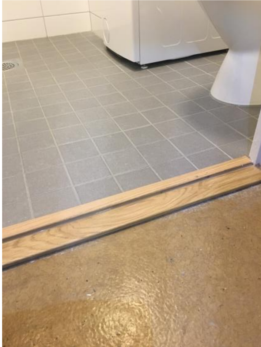
Kuva 17. Perinteisen linjasaneerauksen yhteydessä saatu kylpyhuoneen lattian pinta lähes samaan tasoon eteisen lattian kanssa, ja näin kulkeminen kylpyhuoneeseen on esteettömämpää.
