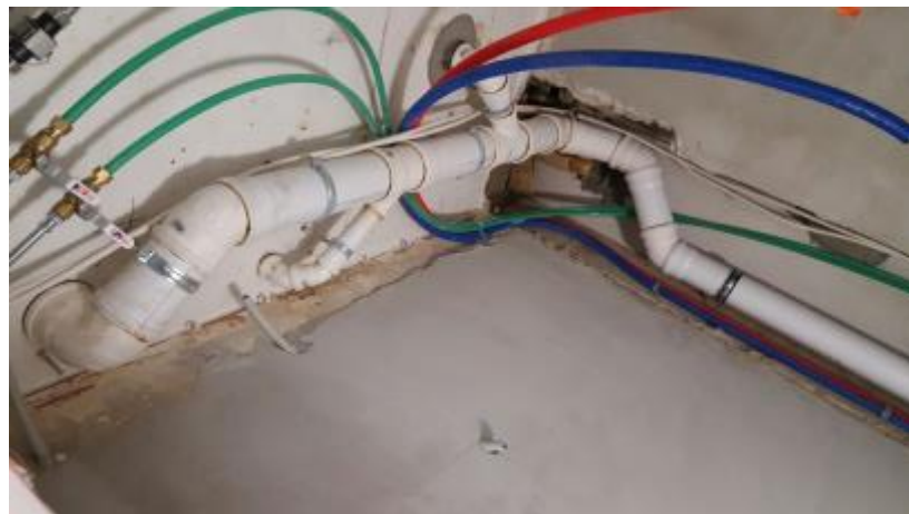
Kuva 10. Db-viemäriin pystynousu sekä viemäriin hajoitukset.
