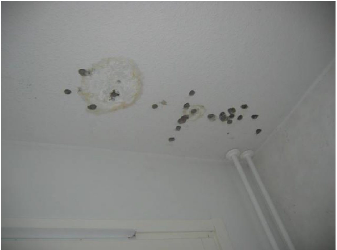
Kuva 22. Onteloveden aiheuttama kosteusvaurio.
