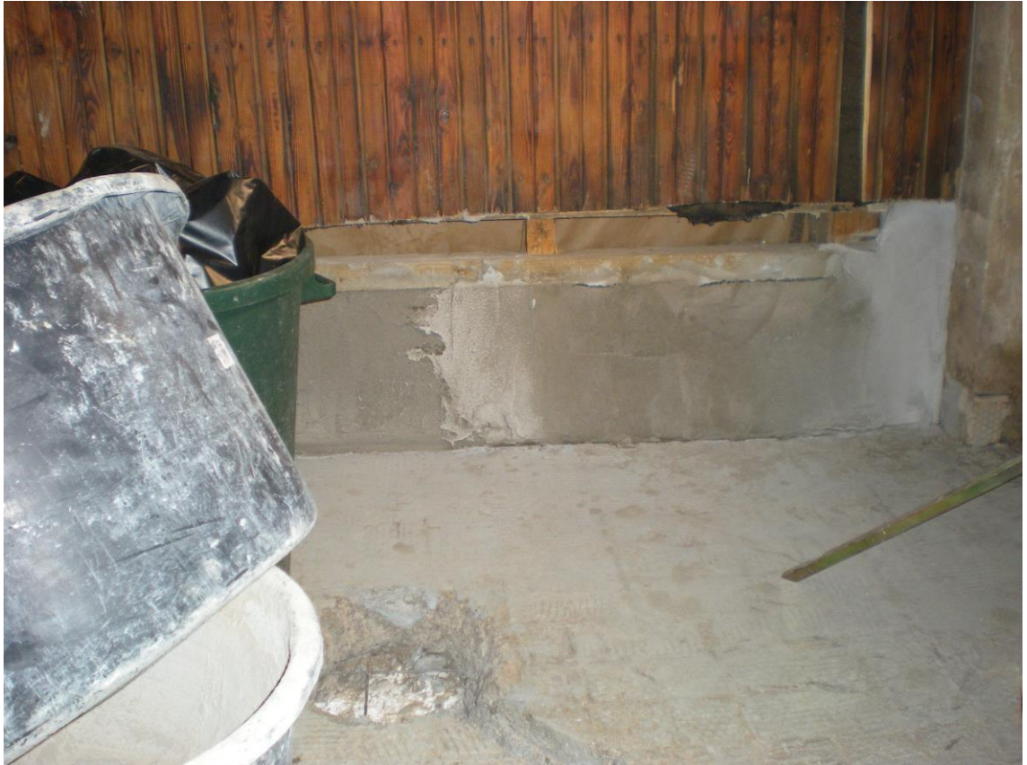
KUVA 7. Miesten puolen pesuhuoneen seinää. Kuvassa etualalla uuden lattiakaivon paikka piikattuna, seinäpaneelien alapäätkatkaistu ja sokkeli oikaistu. (Kuva: Juha Taipainen. 2016)
