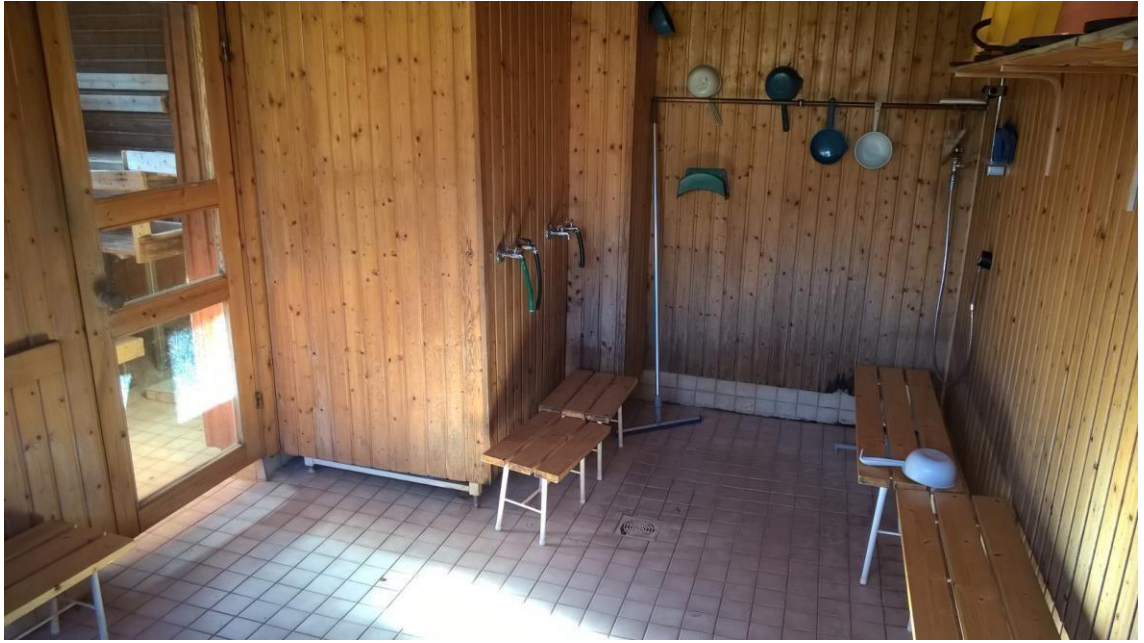
KUVA 4. Naisten puolen pesuhuone. Päätyseinässä selvästi alareunasta tummuneita paneeleita. (Kuva: Juha Taipalinen. 2016)
