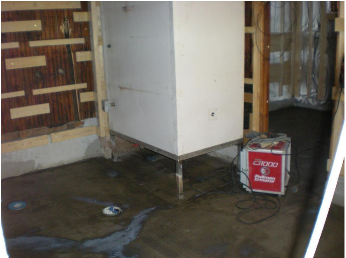
KUVA 9. Miesten puolen pesuhuoneen lattiaa oikaistuna ja primeroituna. Keskellä kuvassa lämminvesivaraaja. (Kuva: Juha Taipalinen. 2016)
