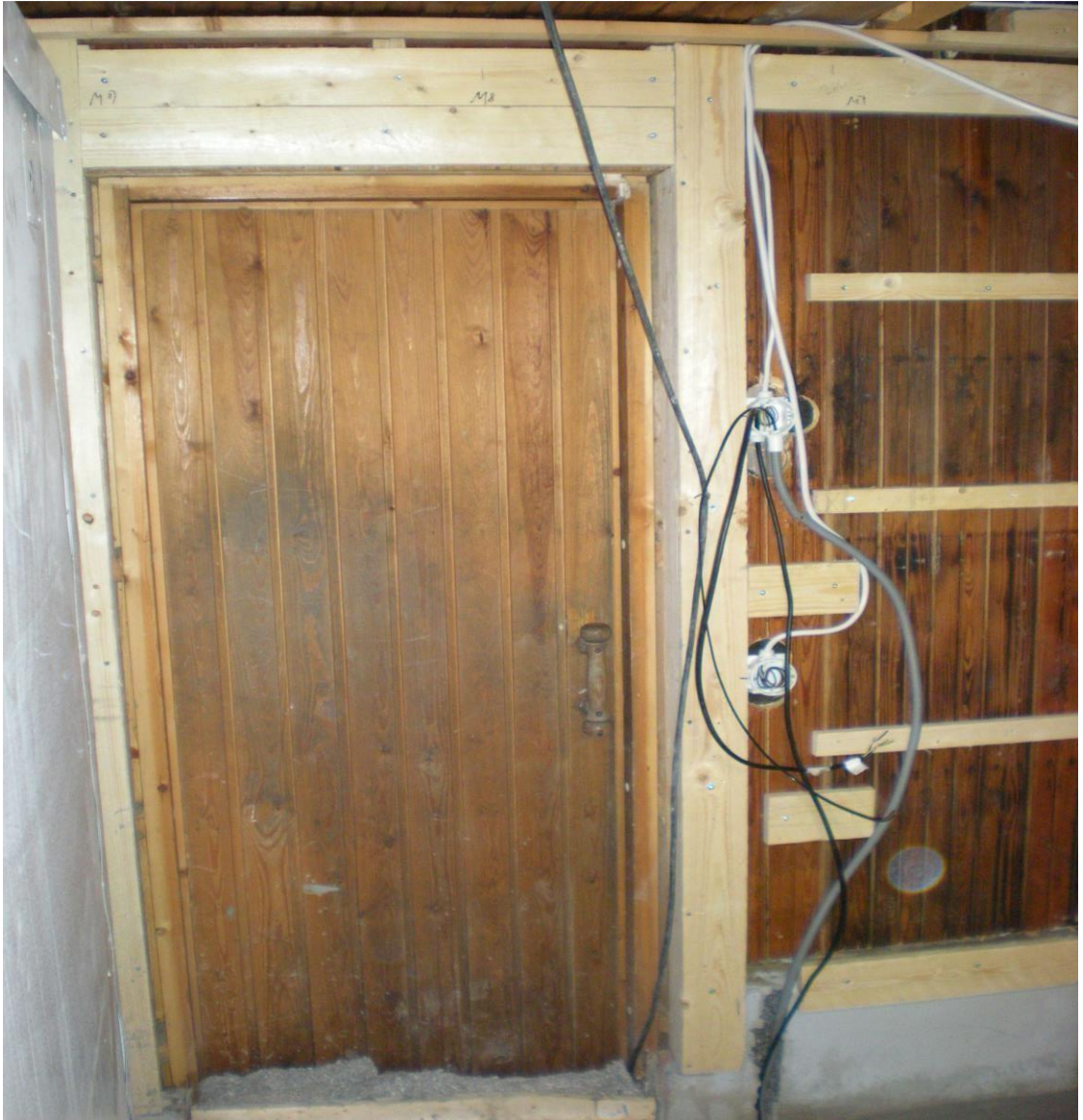
KUVA 13. Pesuhuoneen oven pielessä uudet sähkörsiat lattialämmityksen ohjaukselle ja valokytkimelle. (Kuva: Juha Taipalinen. 2016)
