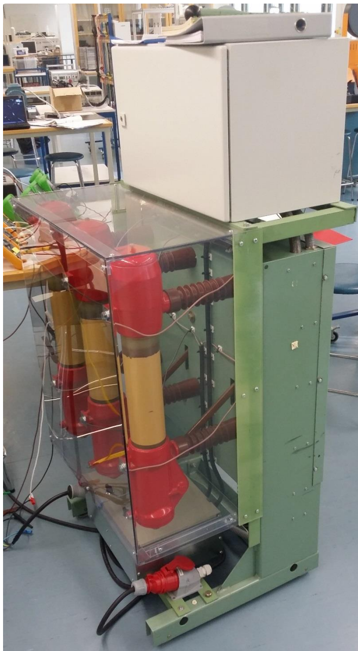
KUVA 20. Katkaisija ja laitteisto (Räsänen, 2016d)
