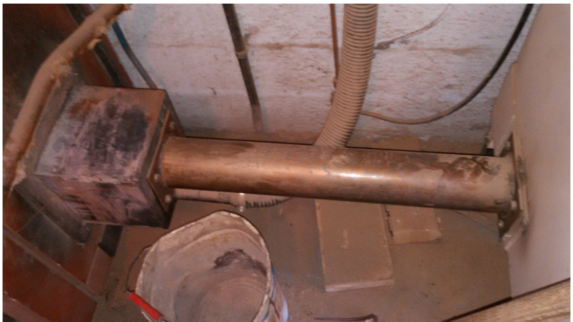
KUVA 8. Säiliön pohjasta lähtevä syöttöruuvin putki, jonka päässä on poltin
