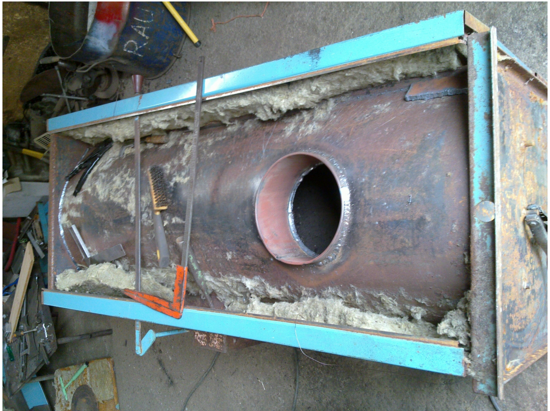
KUVA 25. Vanhan lämmityskattilan kylkeen tehty polttimen reikä
