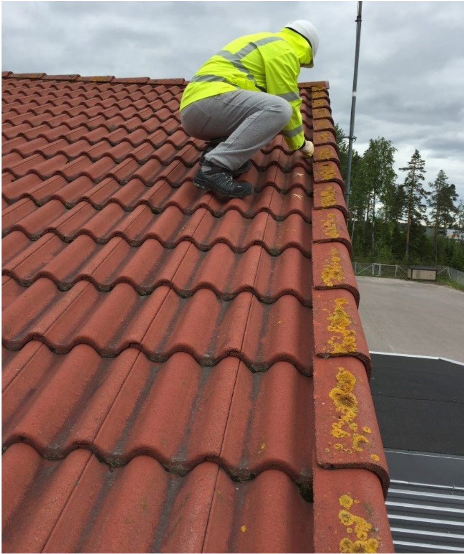
Kuva 22. Eteläpään päätyreunatiilet ennen käsittelyä
