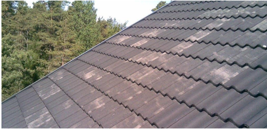
Kuva 2. Vanha ja kulunut betonikattotiili
