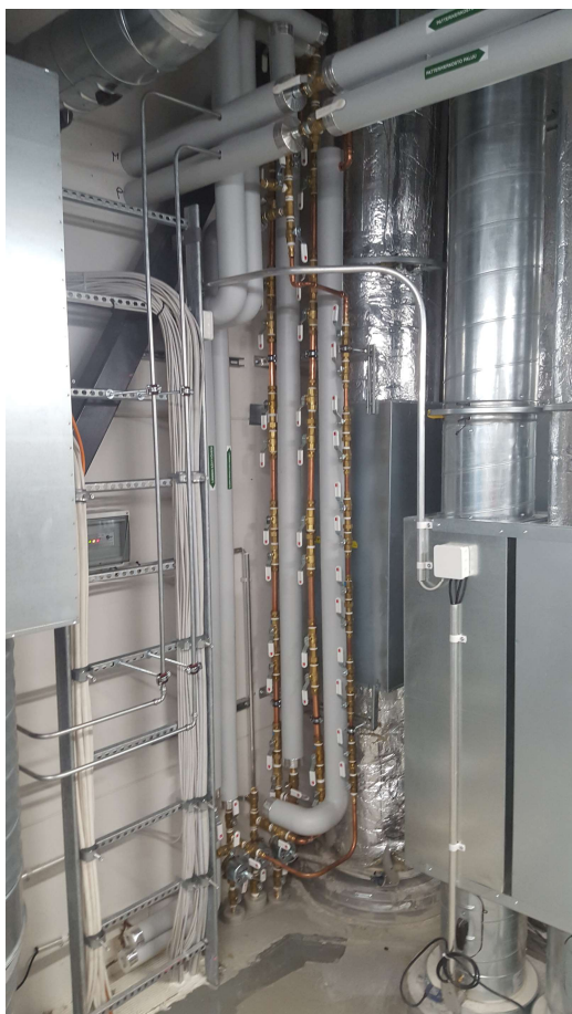
Kuva 10a IV-konehuoneen biofilmikeräimet.
