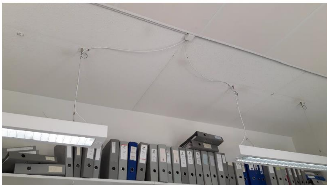
Kuva 3. Katossa näkyy vanhojen valaisinasennuksien jäljet. Yhdestä pintarasiasta on haaroitettu kahdelle valaisimelle syöttö.
