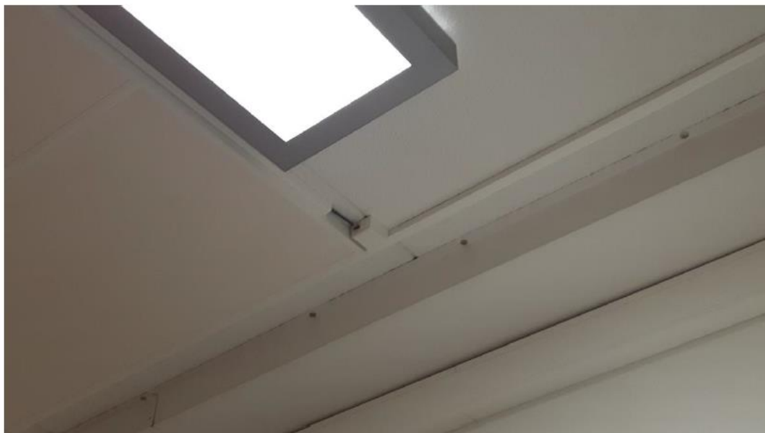
Kuva 2. Kuvassa näkyy pinta-asennus rasia, joka sisältää gatewayn. Cat6-parikaapeli on kytketty RJ45-liittimellä rasiaan. Rasiasta on jatkettu RJ25-liittimellä valaisimeen integroidulle Redwood päivänvalo/läsnäolotunnistimelle. Tunnistimelta on puolestaan jatkettu RJ25-liittimellä valaisimelle.
