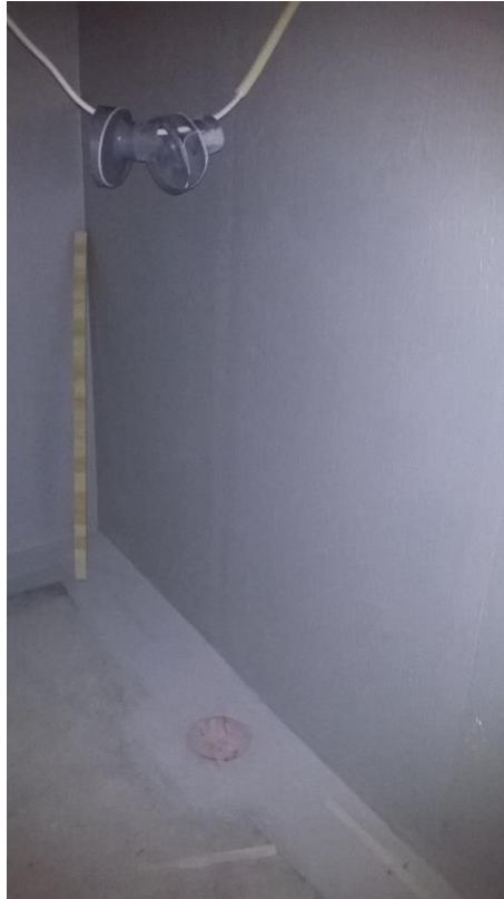
Kuva 18. Vedeneristetty seinä, missä eriste tuotu lattialle noin 200 mm. [13]
