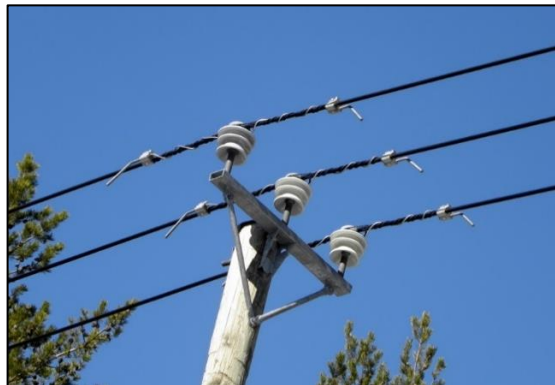
Figure 8. PAS arc protection device. /14/
