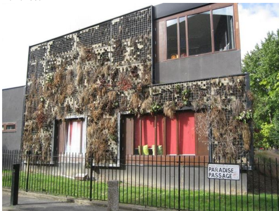
KUVA 31. Kuivunut vihherseinä Lontoossa (Irwin 2015)
