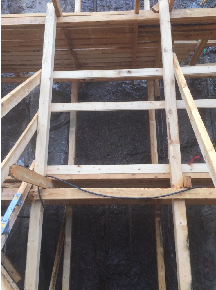
Kuva 10. Rakenteellisesti toteutettu putoamissuojaus E18 Hamina-Vaalimaa tie-työmaalla
