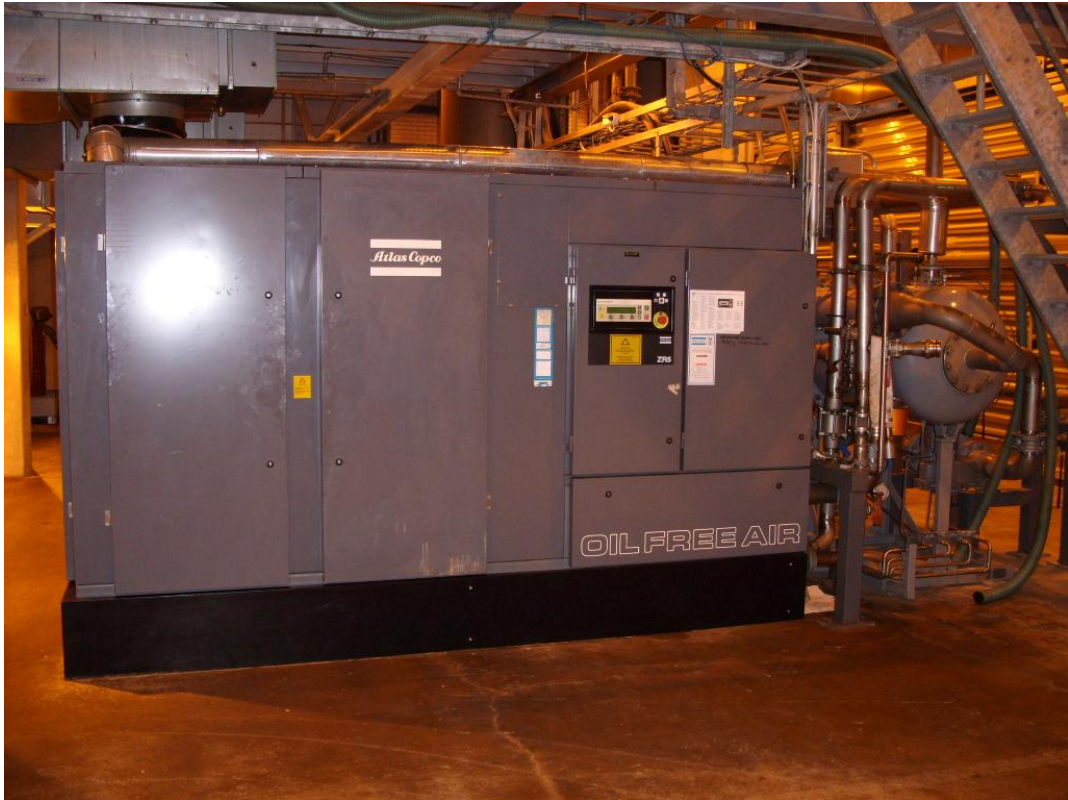
Kuva 3. Kompessori ja sähkömoottorikokonaisuus PK 3:n alakerrassa.
