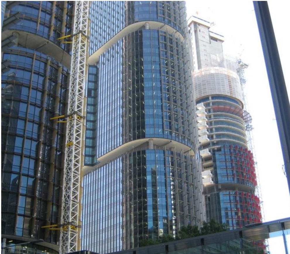
Kuva 11. Rakentamisen aikaisia putoamissuojia oikeanpuoleisessa rakennuksessa. Sydney Australia
