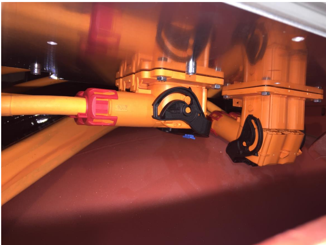
Kuva 17. Korkeajännitekaapeleiden liittimien sijoituspaikan suunnitteluvirhe
