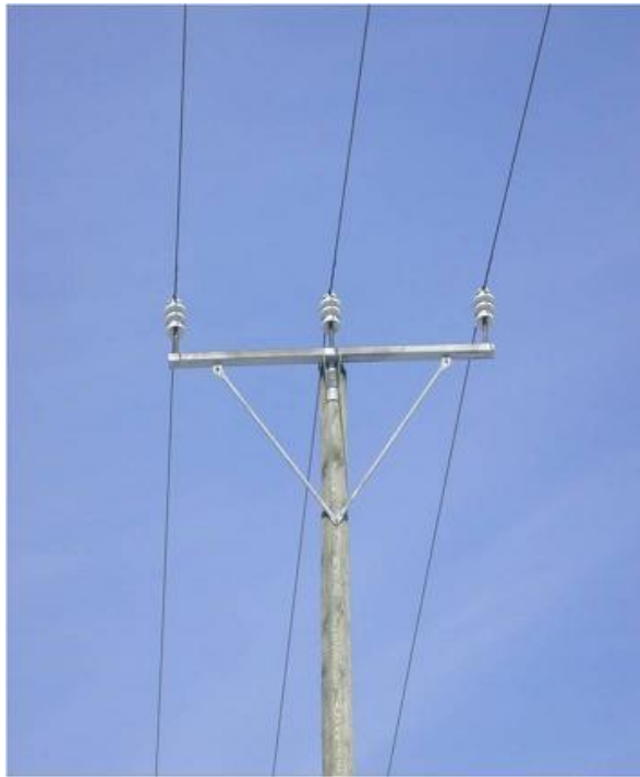
KUVA 1. 20 kV keskijännitelinja (Pohjois-Karjalan sähkö 2017a)
