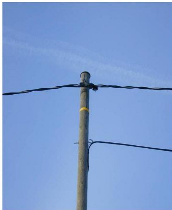
KUVA 2. AMKA pienjännitelinja (Pohjois-Karjalan sähkö 2017b)
