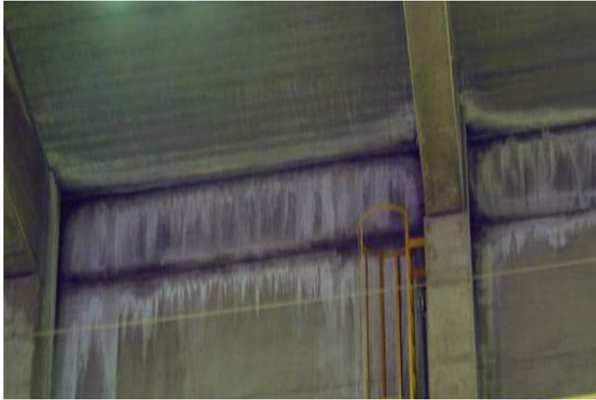
Kuva 32. Kosteus kondensoituu seinärakenteiden pinnoille.
