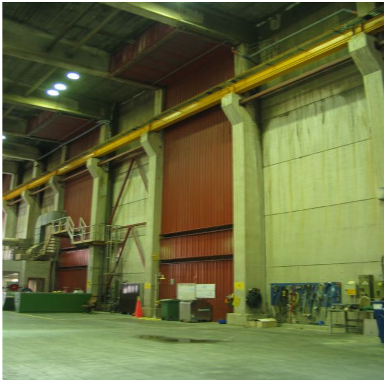
Kuva 2. Tuloilmakanavat pilarien välissä (kanavien pintaan kondensoituu kosteutta)
