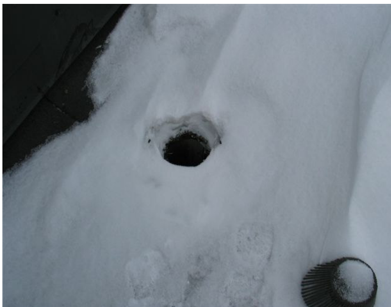
Kuva 12. Konesalin alipaineen johdosta kylmä ulkoilma kulkeutuu sadevesiviemäreihin. Tästä seuraa herkempi kosteuden kondensoituminen putkien pinnoille.
