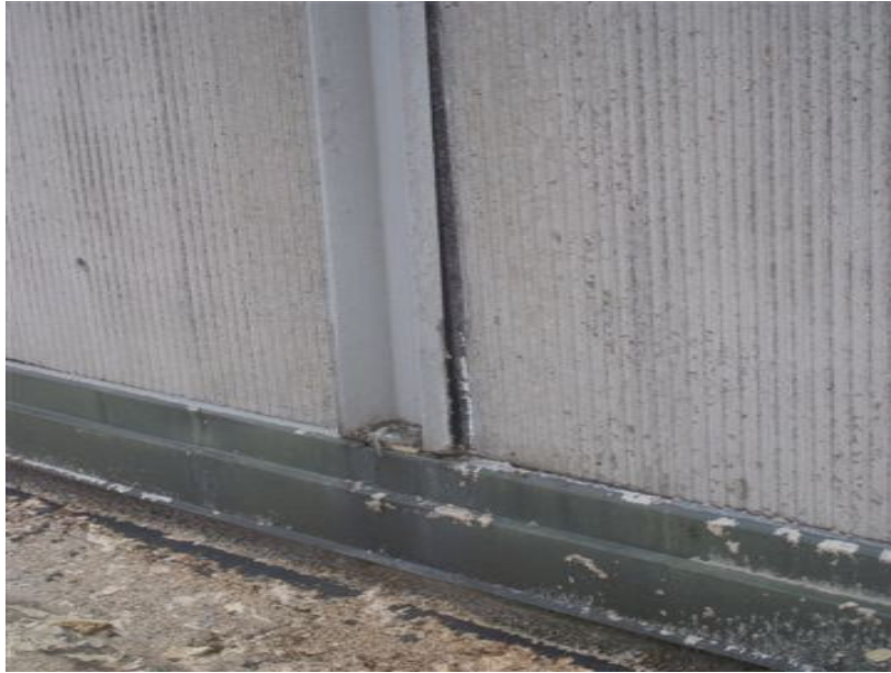
Kuva 13. Seinäelementtien pystysaumojen pellitykset ovat irrallaan.
