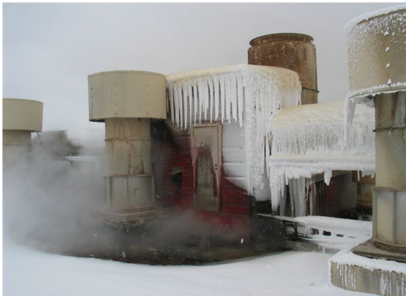
Kuva 11. IV- koneiden poistopuhalluksesta puuttuu pisanerotin, jonka johdosta katoille puhallettava ilma on hyvin kostea.
