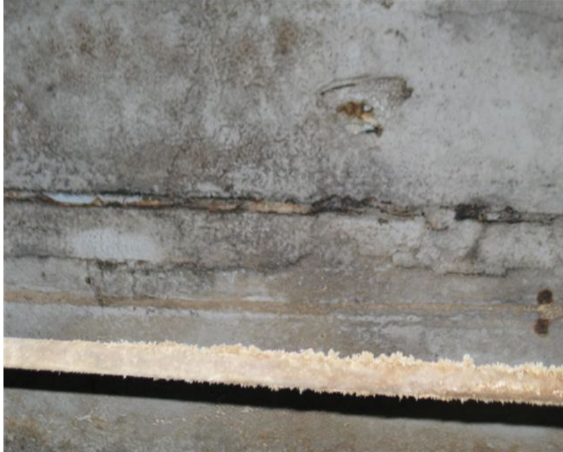
Kuva 5. Katon sisäpinnalle kertynyt likaa.
