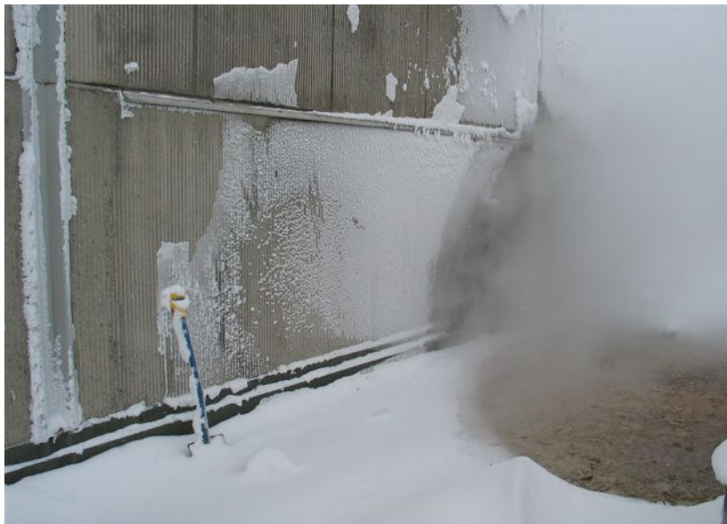
Kuva 8. Katto- ja seinärakenteet joutuvat kovalle rasitukselle etenkin talvella.
