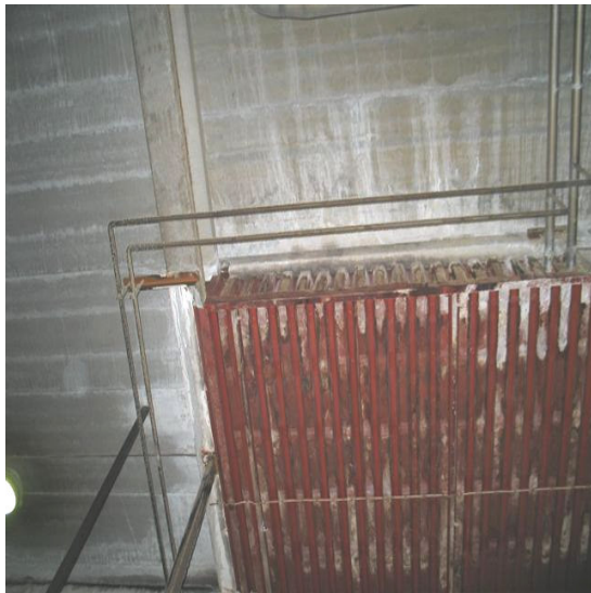
Kuva 25. Kostevauriojälkiä IV-kojeen ympärillä.
