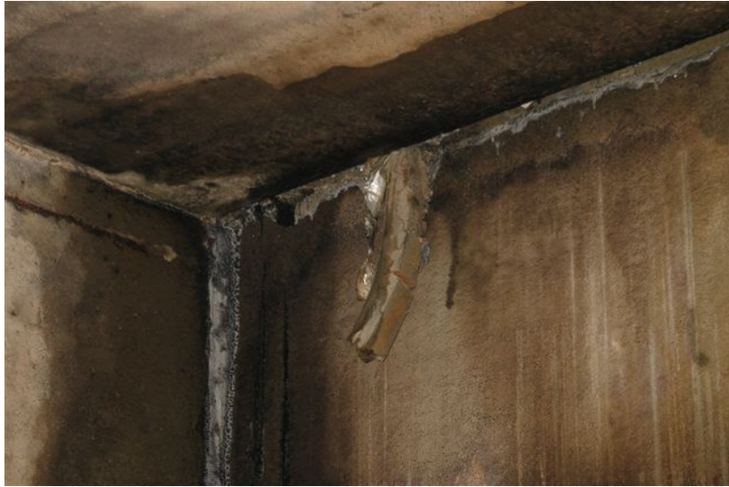
Kuva 9. Kosteus tiivistyy rakenteiden pinnoille.
