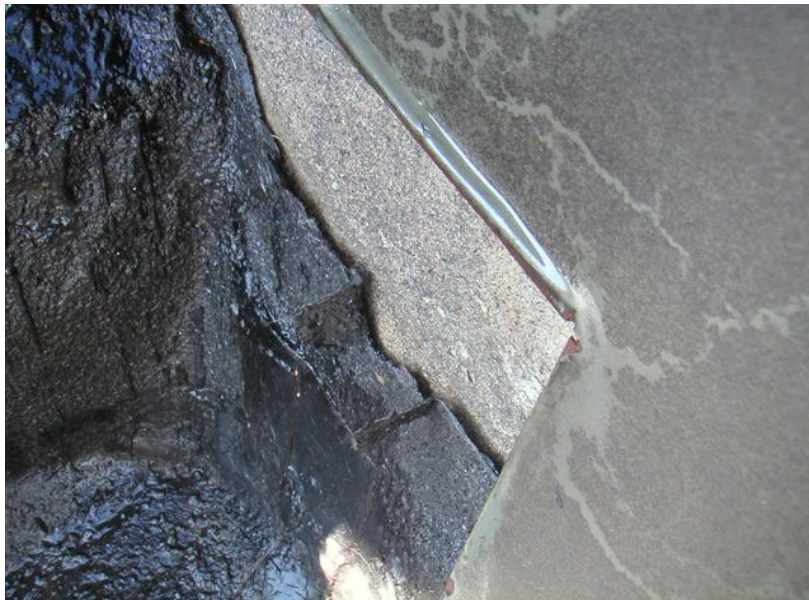
Kuva 16. Katon vedeneristyksen ylösnostot on irronnut paikoitellen.
