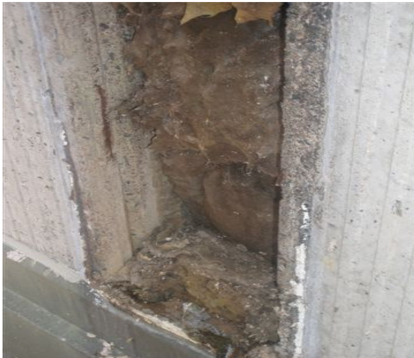
Kuva 14. Betonisandwich- elementtien saumojen lämmöneristeet ovat kastuneet.
