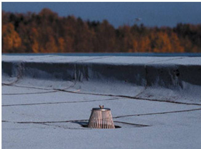
Kuva 13. Sisäpuolisen vedenpoiston kattokaivo [3]
