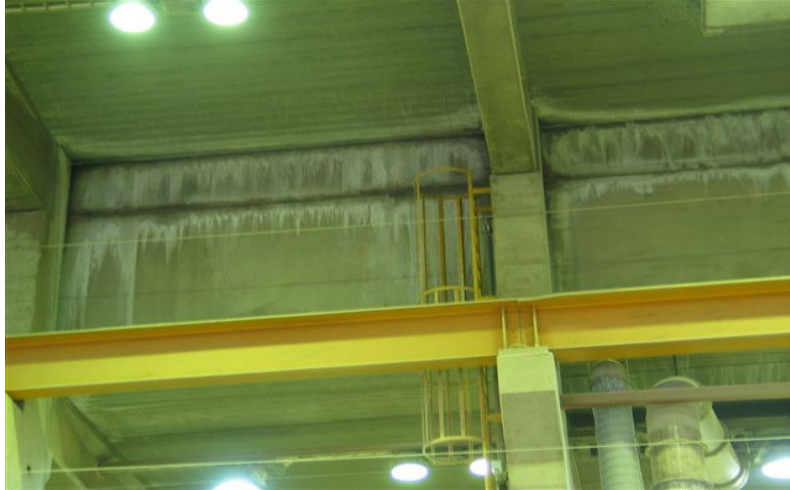
Kuva 1. Konesalin katon kosteusvaurion jälkiä.
