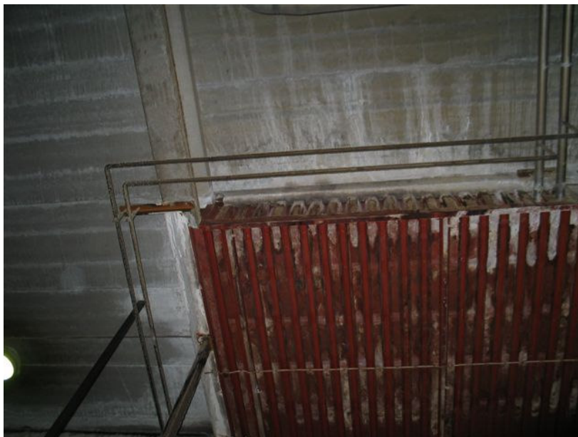
Kuva 10. Vanhoja kosteusvaurion jälkiä.
