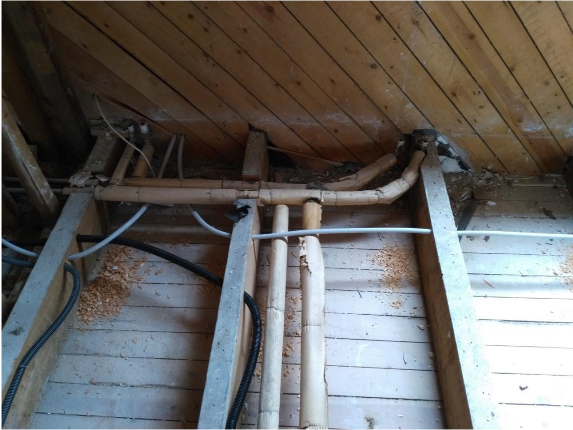
KUVA 7. Asbestikartoituksessa havaitut asbestipitoiset putkieristeet.
