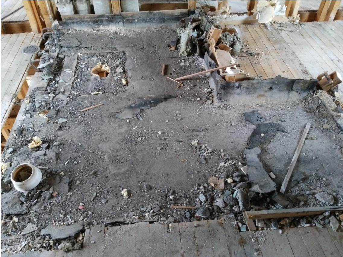
KUVA 8. Kylpyhuoneen betonilaatan alta löytyi asbestia sisältävä bitumikermi.
