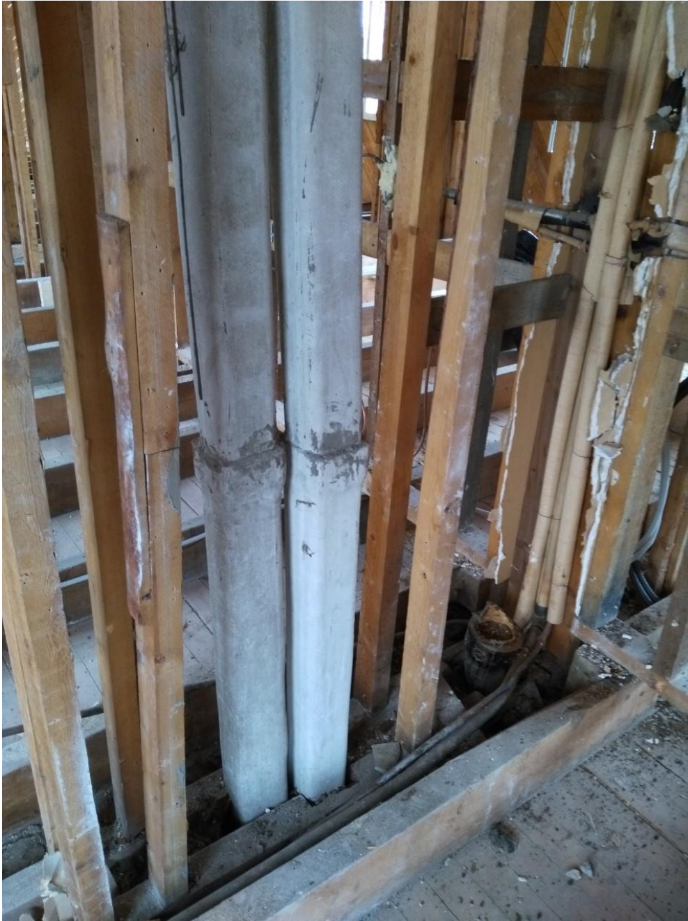
KUVA 9. Mineriiittiä sisältävä asbestiputki.
