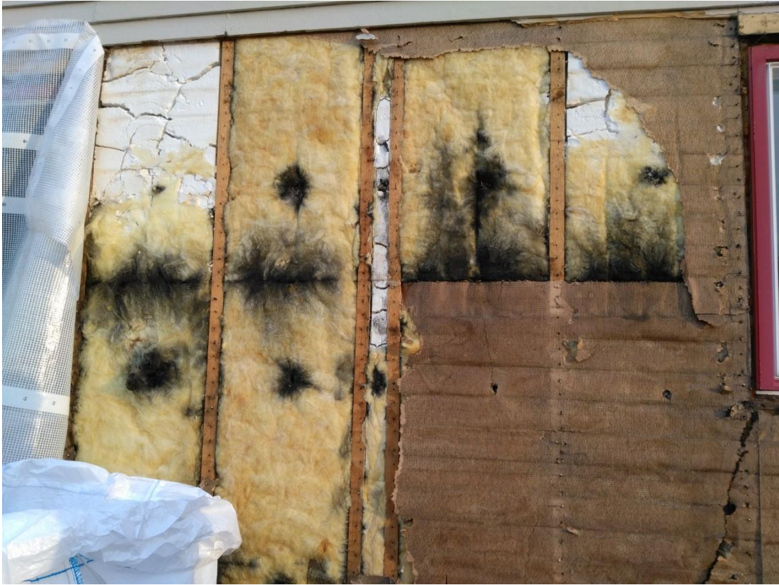
KUVA 3. Ulkoseinän rakenne. Kuvasta näkee lisäeristyksen ja eristeisiin syntyneet vauriot.
