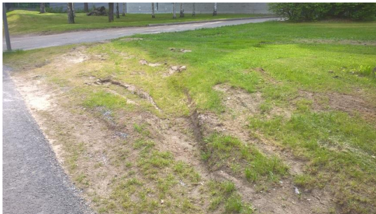
Kuva 23. Alapihan reunakivet puuttuu (Mäkiselkä 2016)
