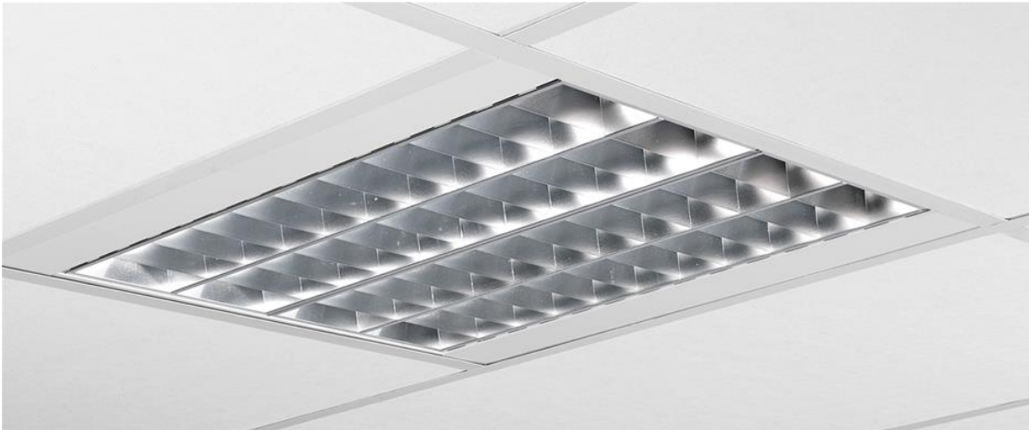
KUVA 17. Työssä käytetty valaisin asennettuna T-listalla toteutettuun alakattoon (21)
