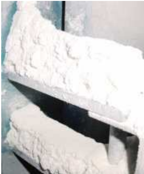
Kuva 3. Pölyn kertymistä rakenteisiin.
