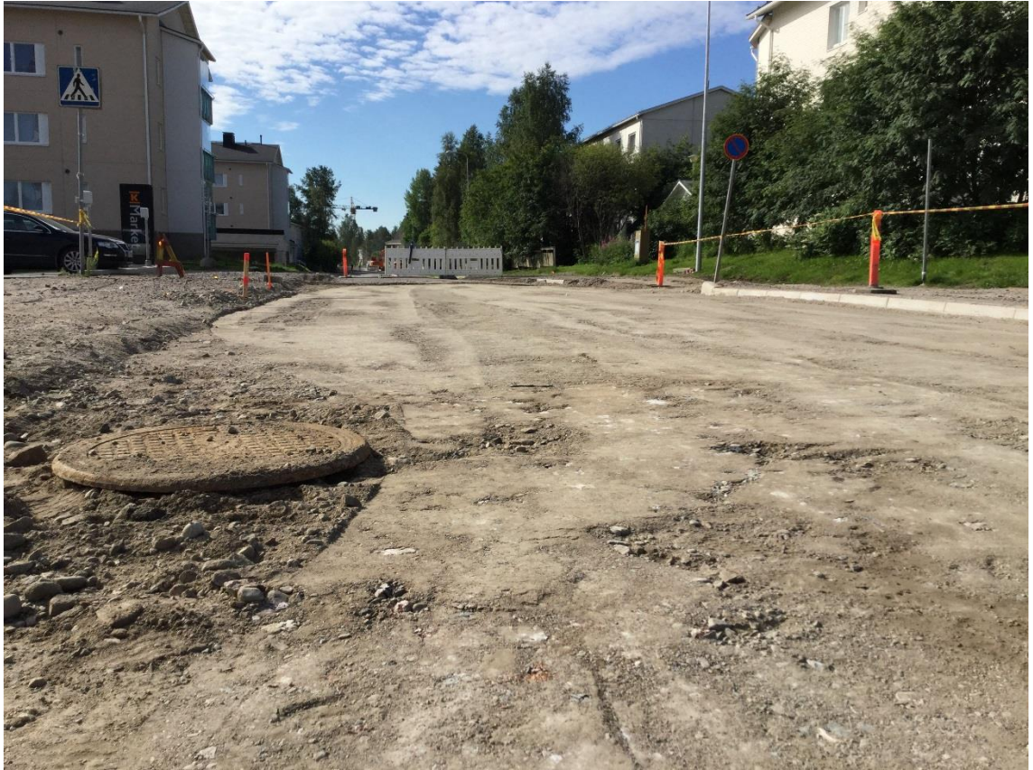
Kuvio 8. Kaivon ympäristöä ei ole tiivistetty tärylätkällä, vaan se on kierretty valssijyrällä
