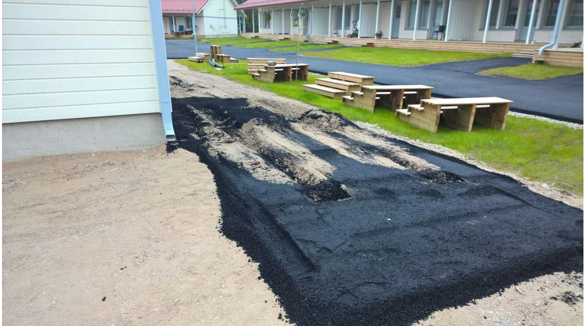
Kuvio 5. Kantavan kerroksen materiaali liian hienojakoista eikä ole tiivistetty kunnolla vettä käyttäen
